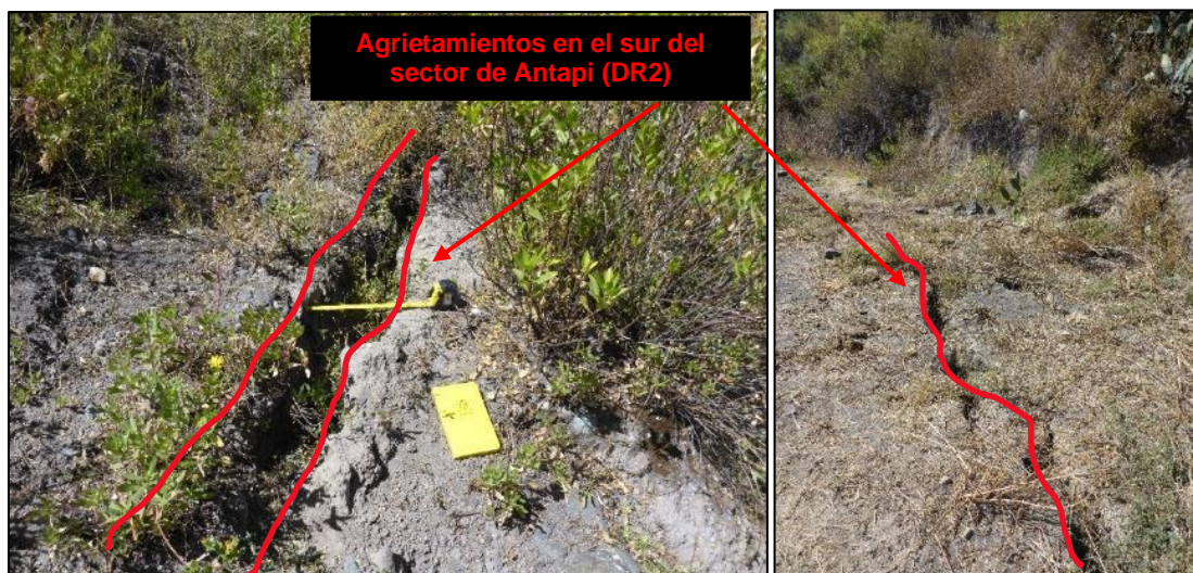
Figura 18. Agrietamientos en el sur del sector de Antapi de 29 cm de ancho, 25 cm de profundidad y 30 m de largo, UTM E: 301871, N: 8186903.
