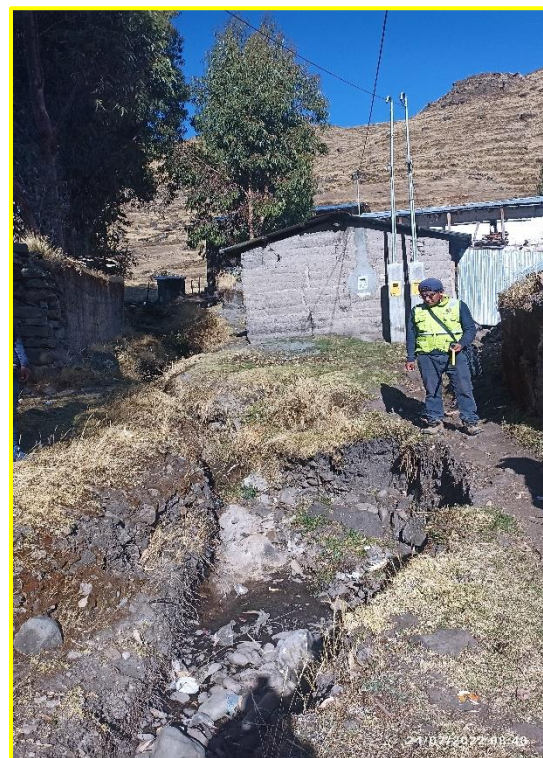
Fotografía N° 10: Levantamiento de la quebrada constatando a simple vista el gran daño de la sección natural, además nótese que colinda con viviendas.
