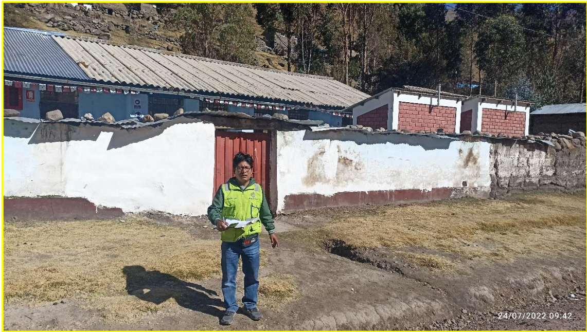
Fotografía N° 18: Vista de la I. E. Inicial construida de material rustico, altamente vulnerable.
