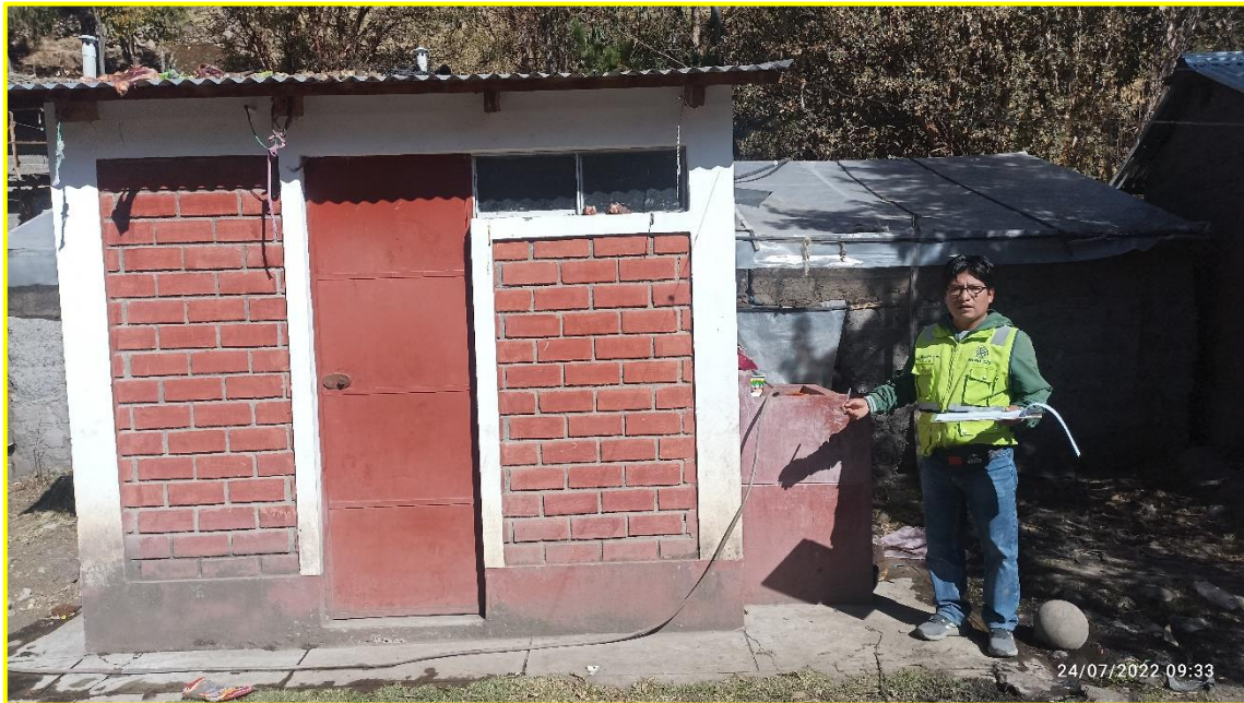
Fotografía N° 21: Vista del servicio de desagüe del tipo letrina.
