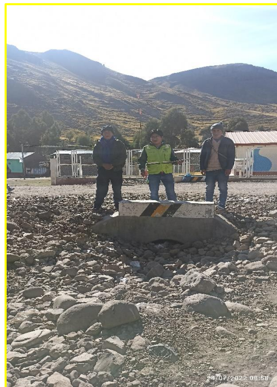
Fotografía N° 14: Vista hacia el este de un canal totalmente obstruido por el arrastre de piedras por el cauce de la quebrada Ranrayocco Huaycco.
