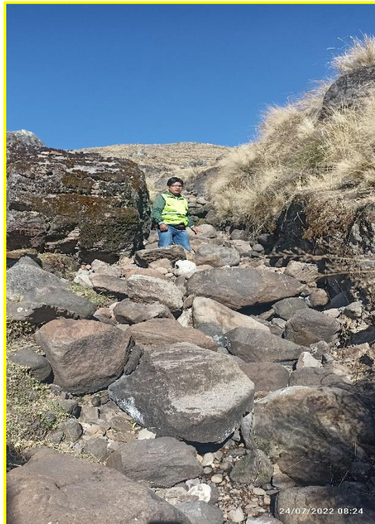
Fotografía N° 07: Levantamiento del cauce de la quebrada Ranrayocc Huaycco identificando daños y obstrucciones, debido al arrastre de rocas por el caudal.
