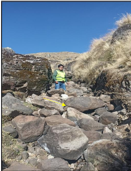
Figura N° 016. Cauce de la quebrada Ranrayocc Huaycco, colmatada de boloneria y gravas gruesas.
