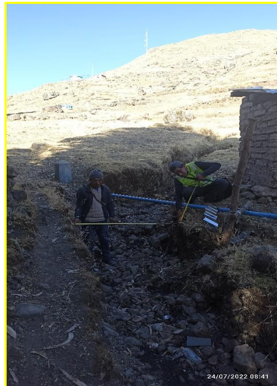
Fotografía N° 09: Vista hacia el oeste del levantamiento de la quebrada Ranrayocc Huaycco, nótese en la imagen viviendas muy cerca al cauce.
