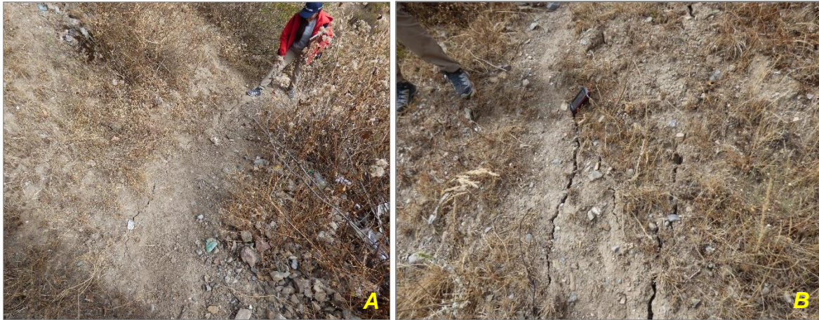
Figura 8. Vista de múltiples agrietamientos longitudinales producidos en la zona posterior a la corona, con aperturas de 20 cm en promedio, en una longitud continua de 70 cm.
