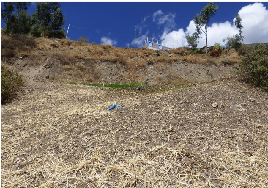
Fotografía 4. Vista de Vertiente coluvio-deluvial, sobre el cual se encuentra asentado parte de las viviendas del centro poblado de Nunupata.
