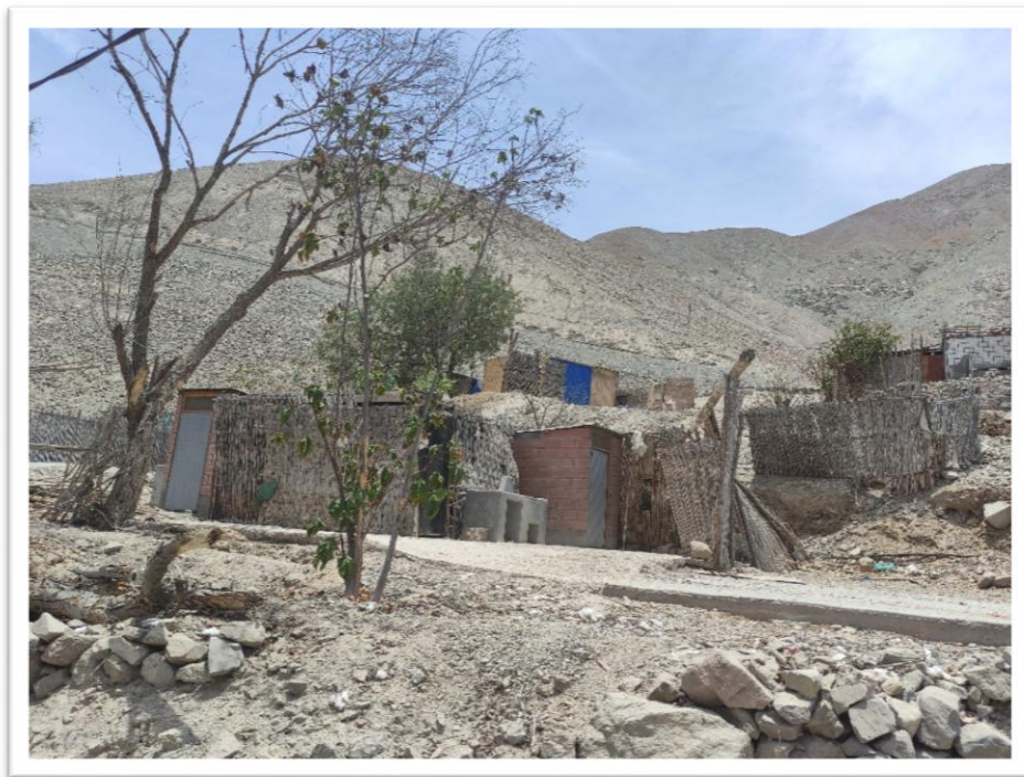
FOTOGRAFÍA 04 VIVIENDA – MATERIAL PREDOMINANTE EN MUROS ESTERA Y CARRIZO, TECHO DE LONA, ESTADO DE CONSERVACIÓN MALO
