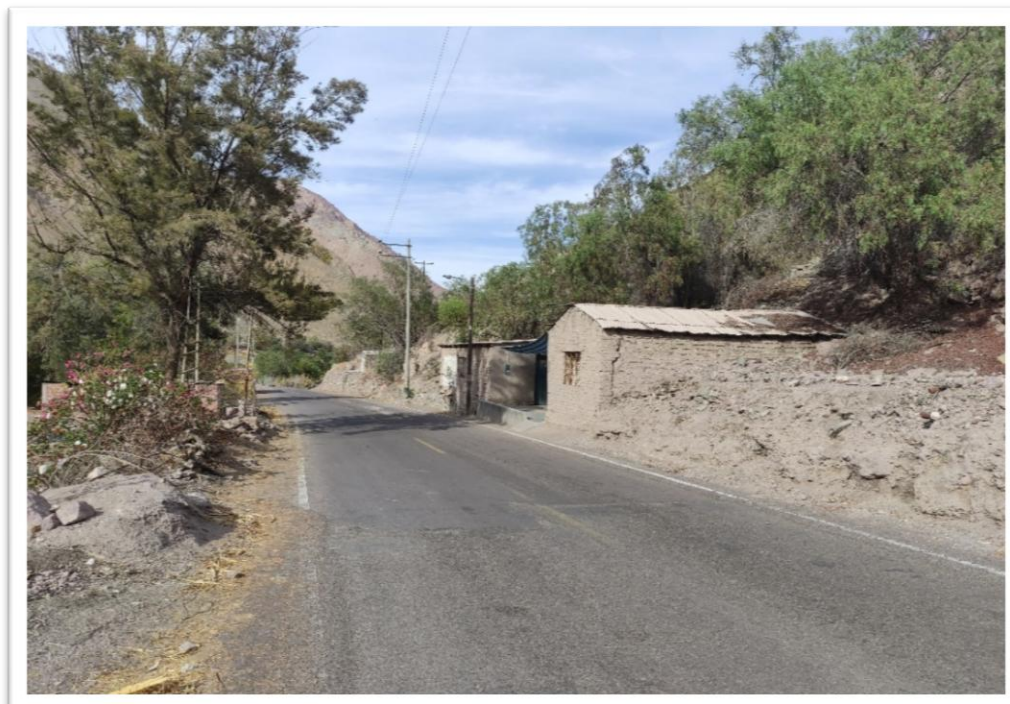
FOTOGRAFÍA 10 VIVIENDA – MATERIAL PREDOMINANTE EN MUROS ADOBE, TECHO DE CALAMINA, ESTADO DE CONSERVACIÓN REGULAR
