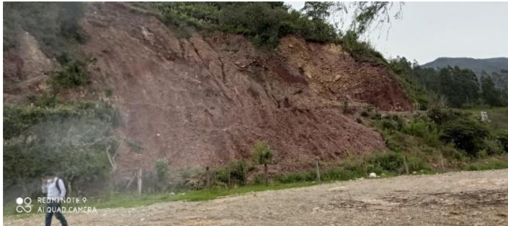
Figura 22. Vista del deslizamiento en el primer tramo de la vía Pipus – Cheto. Fuente: Municipalidad provincial de Chachapoyas
