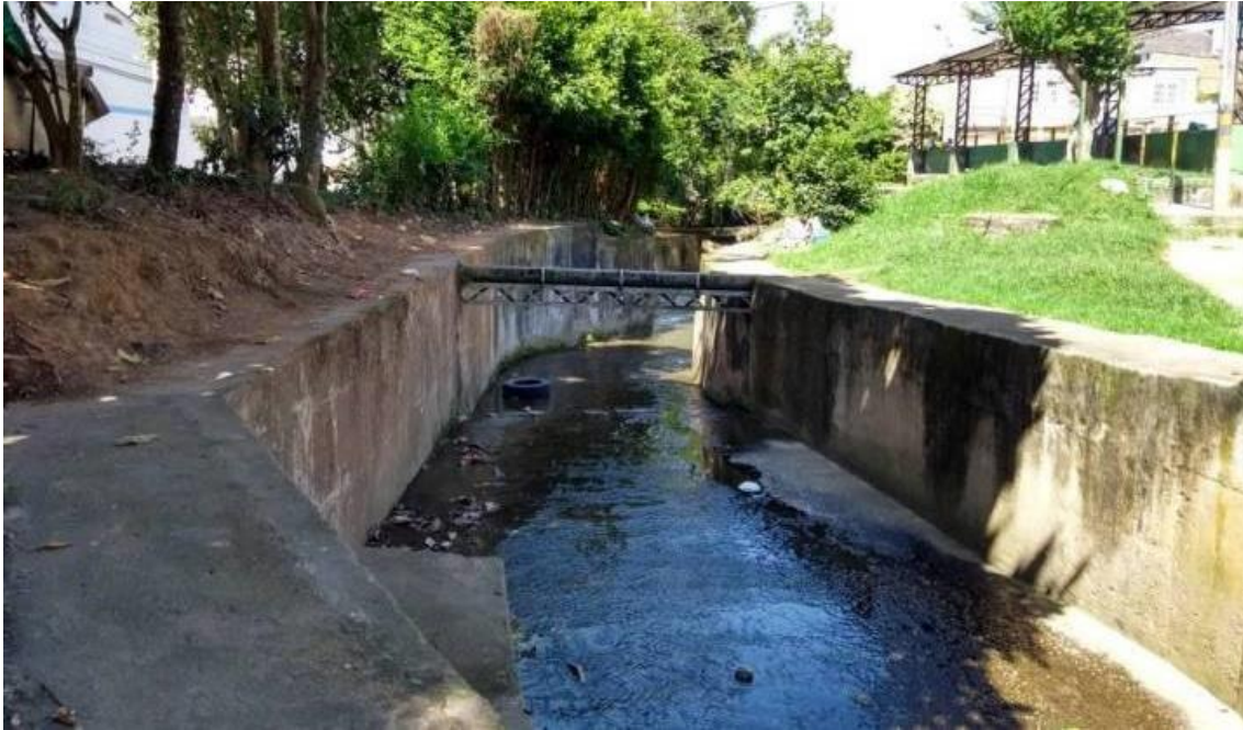
Figura 23. Ejemplo de canalización en quebrada.
