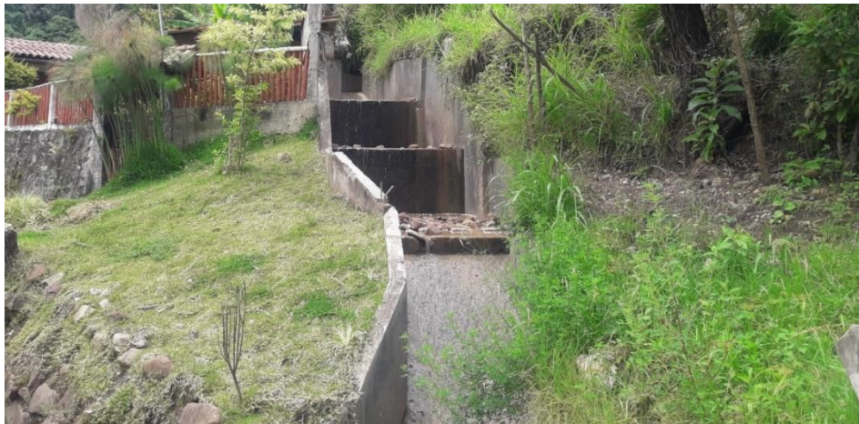
Figura 20. Vista actual a la canalización de la quebrada Chilchos. Fuente: Municipalidad Provincial de Chachapoyas.
