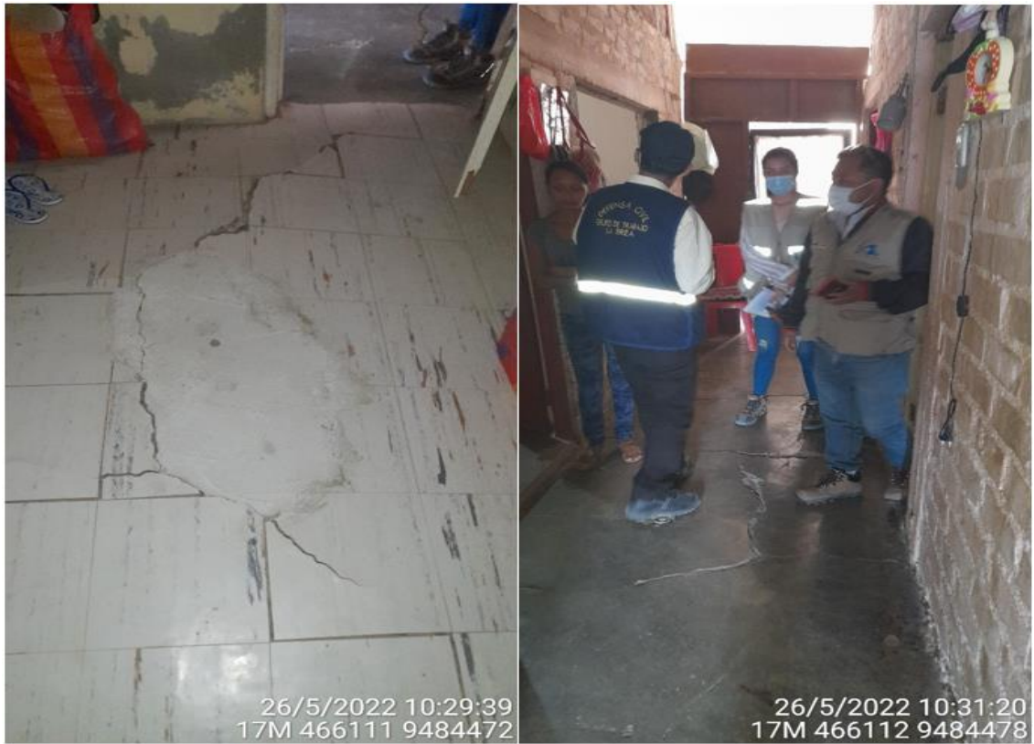
Figura 22.- Grietas en pisos de viviendas y deformaciones verticales positivas (levantamientos)
