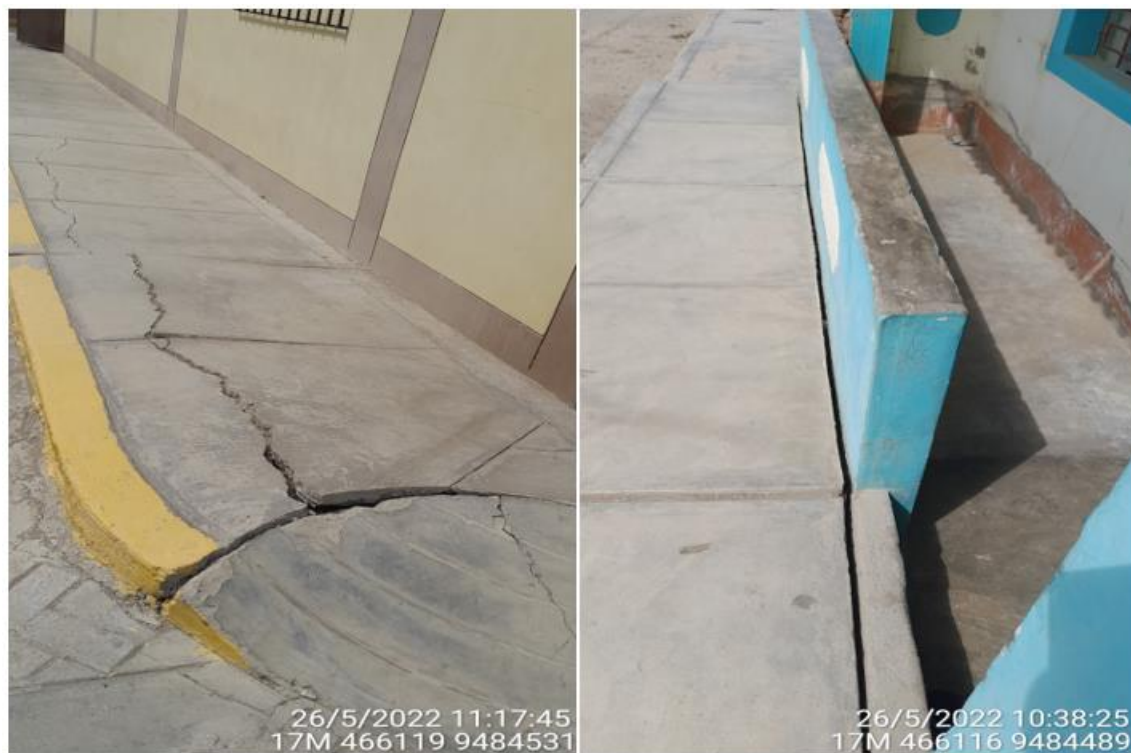
Figura 23.- Grietas en veredas de la calle Las Magnolias y deformaciones verticales positivas (levantamiento del suelo)
