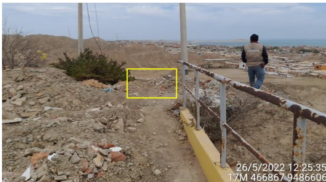
Figura 17.- Derrumbe o caída de suelos (polígono amarillo) identificado en el extremo suroeste del estacionamiento del cementerio que se ubica sobre una loma conformada por areniscas y lutitas, además ha sido cubierto por materiales antrópicos (deshmorte)
