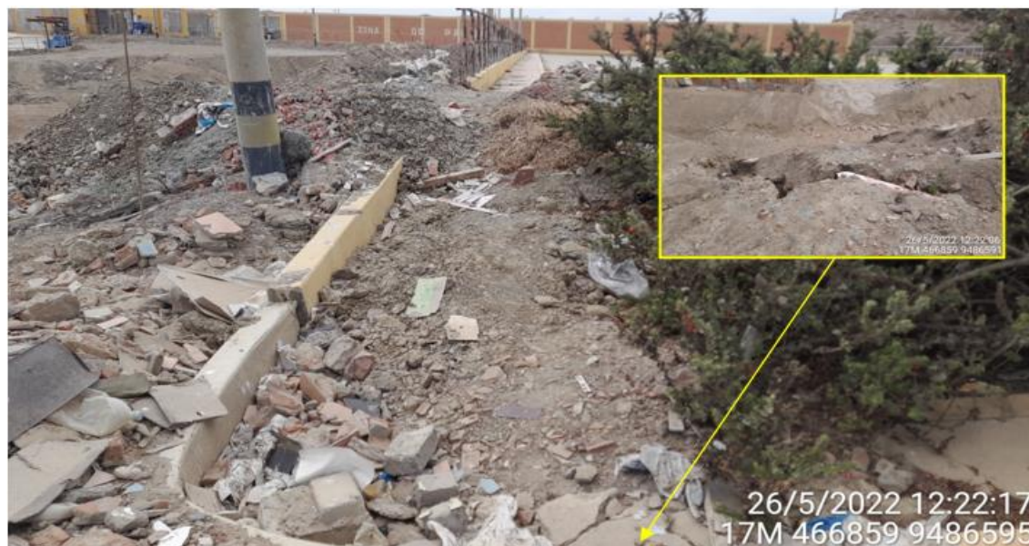
Figura 18.- Asentamiento de veredas e inclinación de postes como evidencia de derrumbes o caída de suelo en el extremo suroeste del estacionamiento del cementerio municipal debido a la deficiencia de drenaje pluvial (en la figura de contorno amarillo se aprecia tuberías que drenan las aguas en la parte media de las laderas) generando la inestabilidad de los materiales
