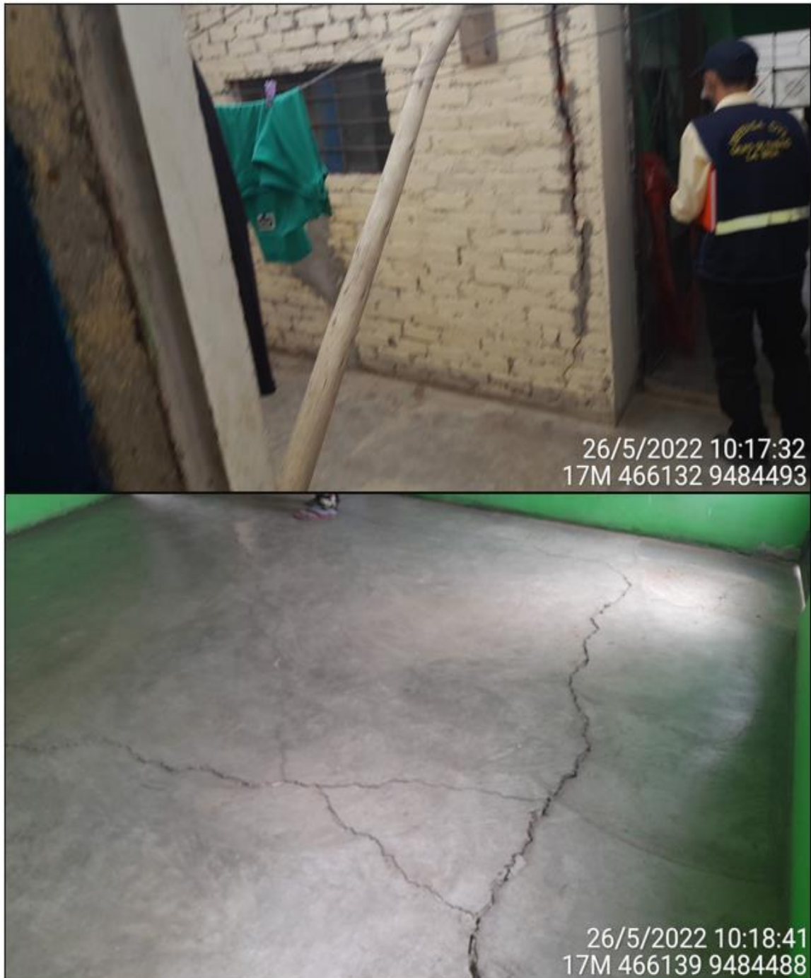
Figura 21.- Grietas en paredes de viviendas y pisos con presencia de levantamiento del suelo, en la imagen superior se aprecia un palo para contener la pared y evitar su colapso
