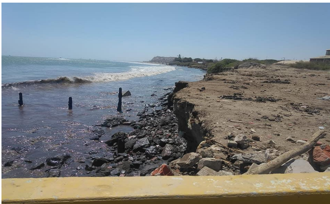
Figura 20.- Erosión marina en las inmediaciones de la zona de playa de Negritos (Fuente: Web Salvando mi playa Negritos, 2021)
