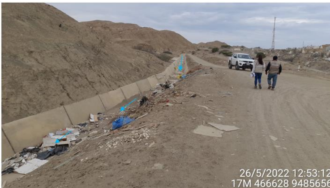
Figura 16.- Canal de captación que colecta las aguas de la parte superior de la quebrada San Vicente y las escorrentías superficiales provenientes de las lomas ubicadas hacia el extremo oriental de Negritos hasta su desembocadura en las inmediaciones de la quebrada Micaela Bastidas
