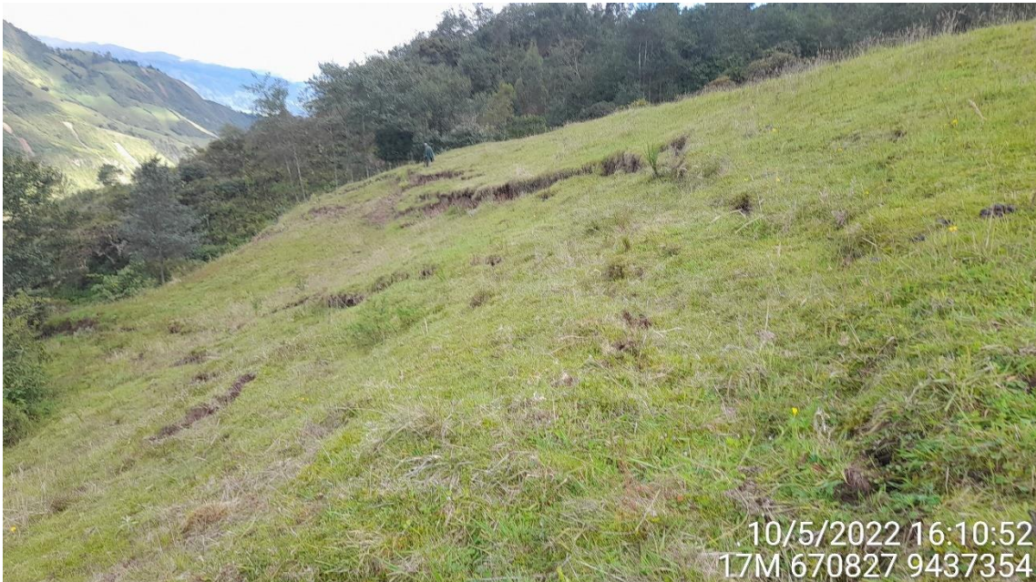
Figura 34.- Asentamientos diferenciales de los suelos con desniveles de 0.50 m que han sido identificados sobre laderas situadas a 900 m al norte de la institución educativa 14473, entre los efectos reconoció una vivienda precaria con grietas en su estructura
