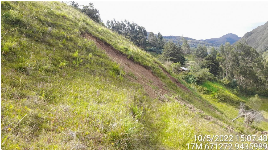
Figura 35.- Caída de suelos o derrumbes sobre laderas ubicadas alrededor de caserío Huar Huar, la figura muestra evento a 500 m al sureste de la institución educativa N°14473
