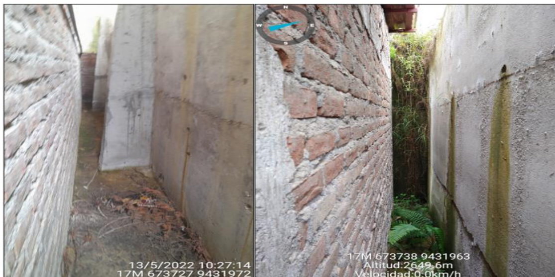
Figura 26.- Muro de concreto ubicado detrás de capilla del caserío Pulun mostrando áreas de acumulación de agua
