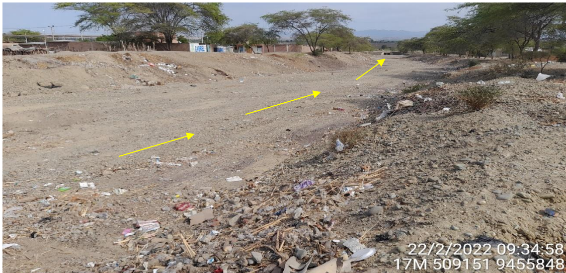
Figura 15.- Cauce de la quebrada La Zorra que se encuentra estrangulado en las inmediaciones de la vía Viviate – Paíta por la presencia de un pontón que podría ser colmatado y generar afectaciones en la vía y viviendas contiguas
