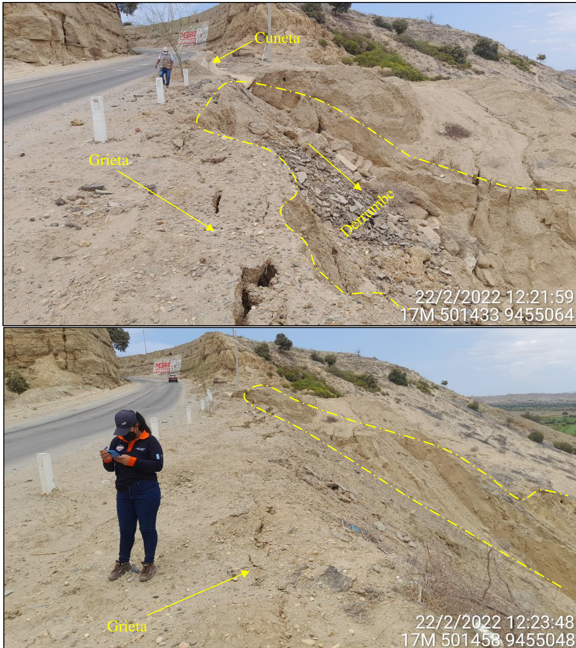
Figura 19.- Derrumbe (línea amarilla) generado por la erosión del agua de escorrentía pluvial que viene siendo transportada a través de la cuneta de la vía
