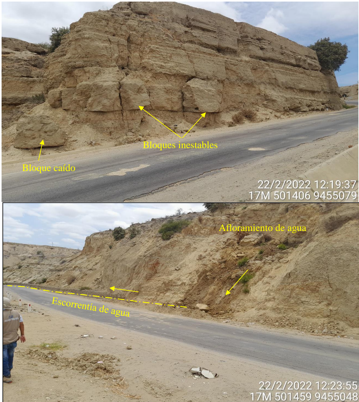
Figura 17.- Eventos geodinámicos en las inmediaciones de la vía Vivate – Paita, la imagen superior muestra rocas fracturadas susceptibles a desprenderse y en la imagen inferior se evidencia un flujo de agua que resulta de la infiltración de las aguas de riego empeladas en la parte alta de la ladera para el regadío de cultivos de caña de azúcar que contribuyen en el incremento de la inestabilidad
