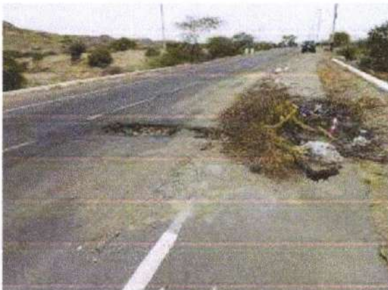
Figura 21. Efectos del sismo de 30 de julio de 2021 en el sector Transportes Región Piura.
