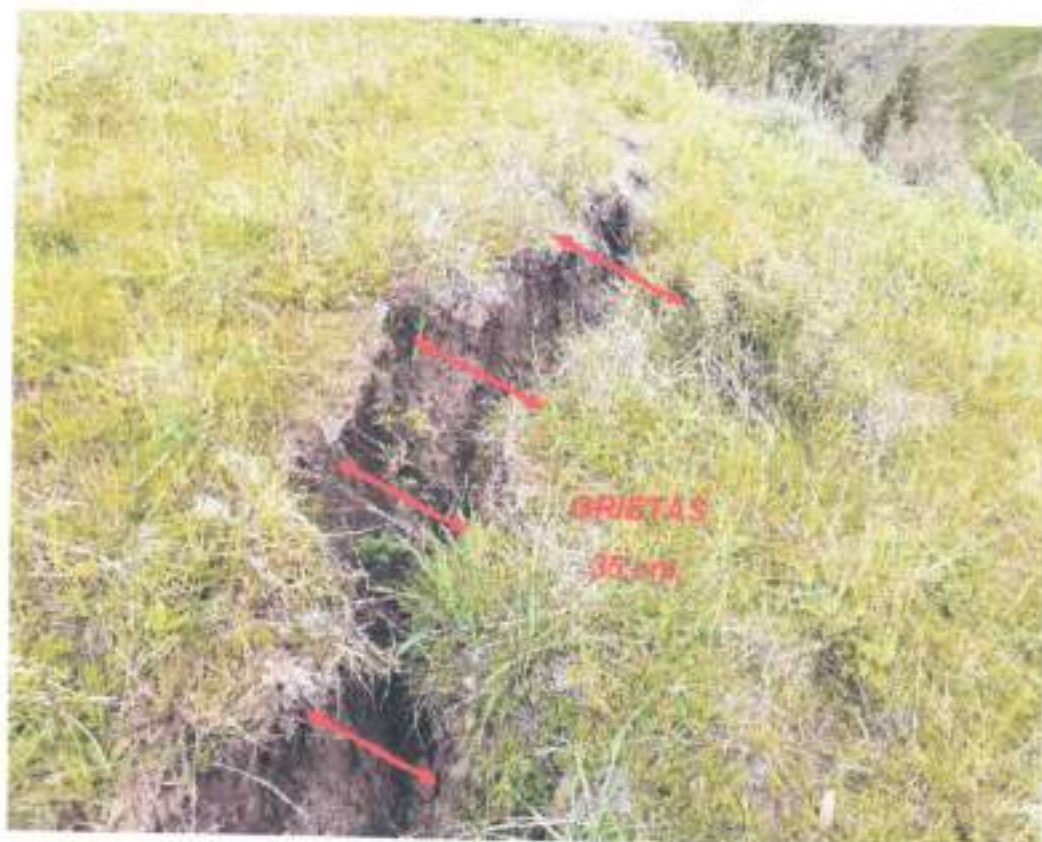
Imagen 17 : Grietas pronunciadas del suelo de una dimensión aproximada de 35 cm.
