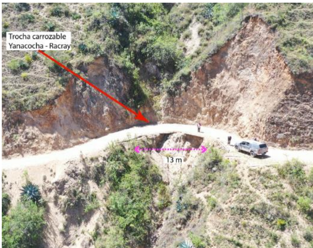
Figura 31: Vista de la erosión en cárcava, con coordenadas UTM (WGS 84): 356231 E; 8856690 N, donde por la erosión retrogresiva en sus márgenes, presenta un ancho de 13 m y profundidad de 3 m
