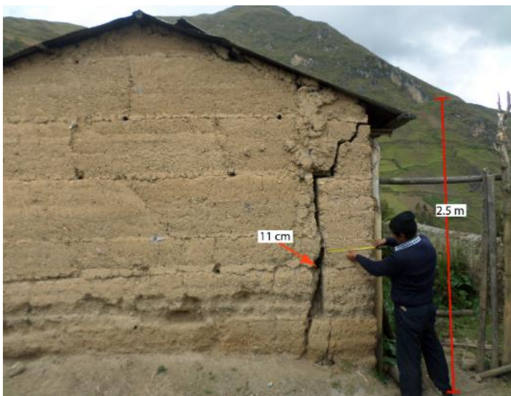
Figura 25. Vista de vivienda cuya pared presenta grietas con 5 cm a 11 cm de abertura y una longitud de 2.5 m, producto de los sismos ocurridos en marzo del año 2022, ubicado con coordenadas UTM (WGS 84): 357690.82 E; 8856419.55 N.
