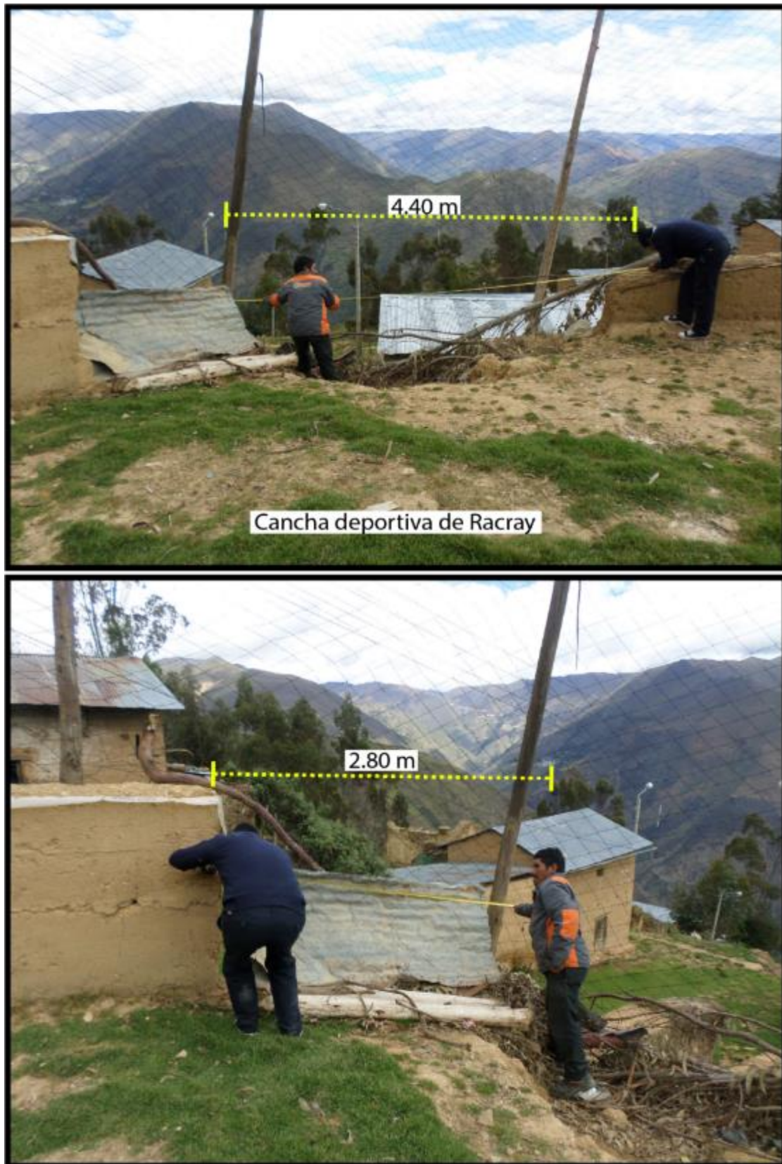
Figura 27. Vista del muro colapsado producto de las lluvias intensas, ubicado en la cancha deportiva del poblado Racray (un total 7.20 metros) 0 con coordenadas UTM (WGS 84): 357755.74 E; 8856493.88 N.
