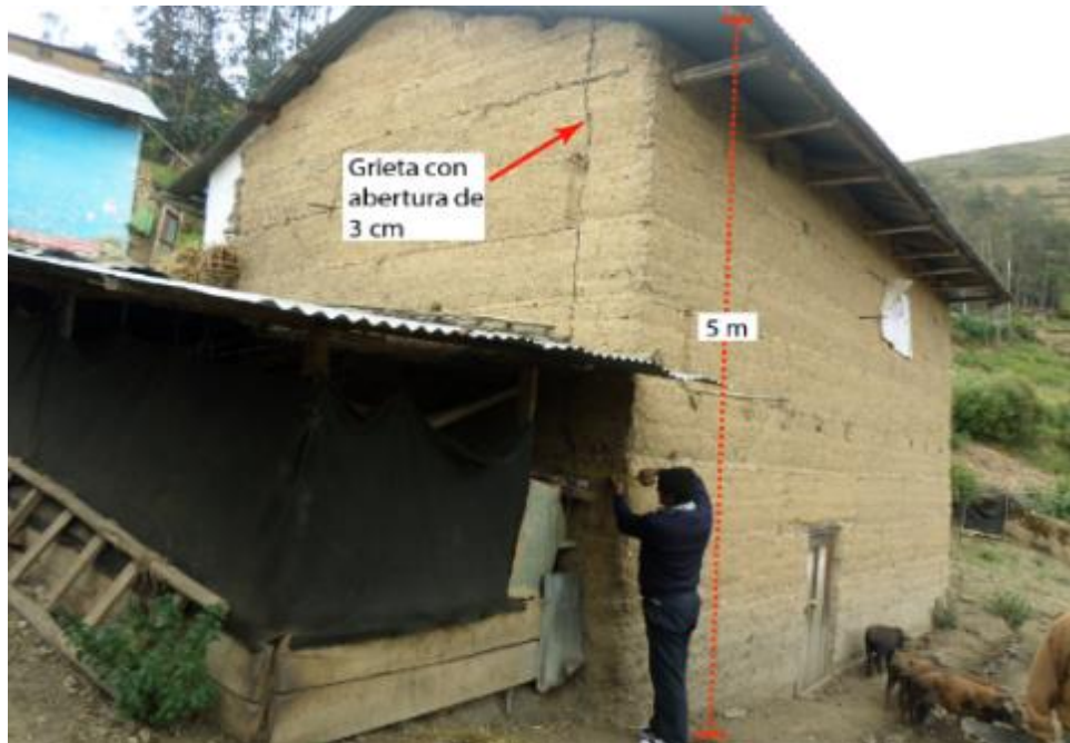
Figura 24. Vista de vivienda cuya pared presenta grietas con 3 cm de abertura y una longitud de 5 m, producto de los sismos ocurridos en marzo del año 2022, ubicado con coordenadas UTM (WGS 84): 357632 E; 8856354 N.
