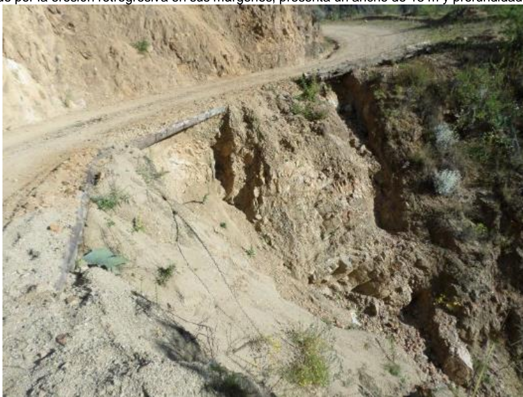
Fotografía 8: Vista de la erosión en cárcava que afecta un tramo de 20 m de la trocha carrozable que conecta los poblado Yanacocha y Racray, para habilitar el pase vehicular los pobladores colocan troncos de eucalypto (Coordenadas UTM (WGS 84): 356231 E; 8856690 N).
