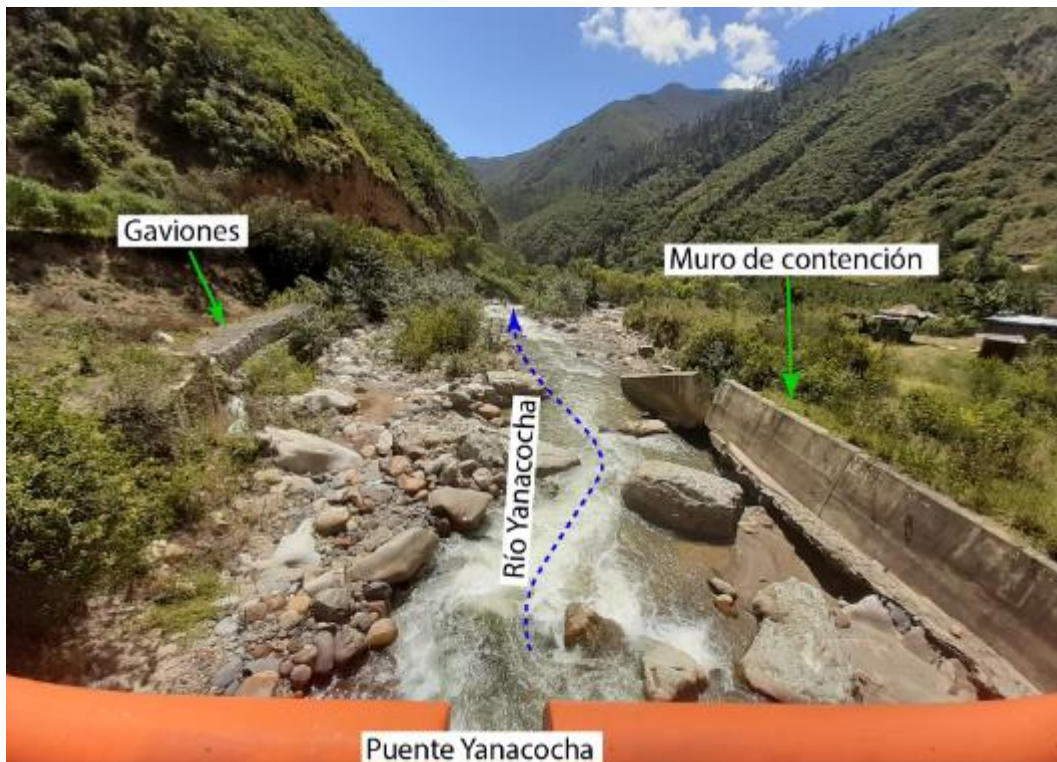
Figura 28: Vista de defensas riberenas tipo gaviones en el margen izquierdo y muro de contención de concreto en la margen derecha, con coordenadas UTM (WGS 84): 355695.10 E; 8856407.13 N.
