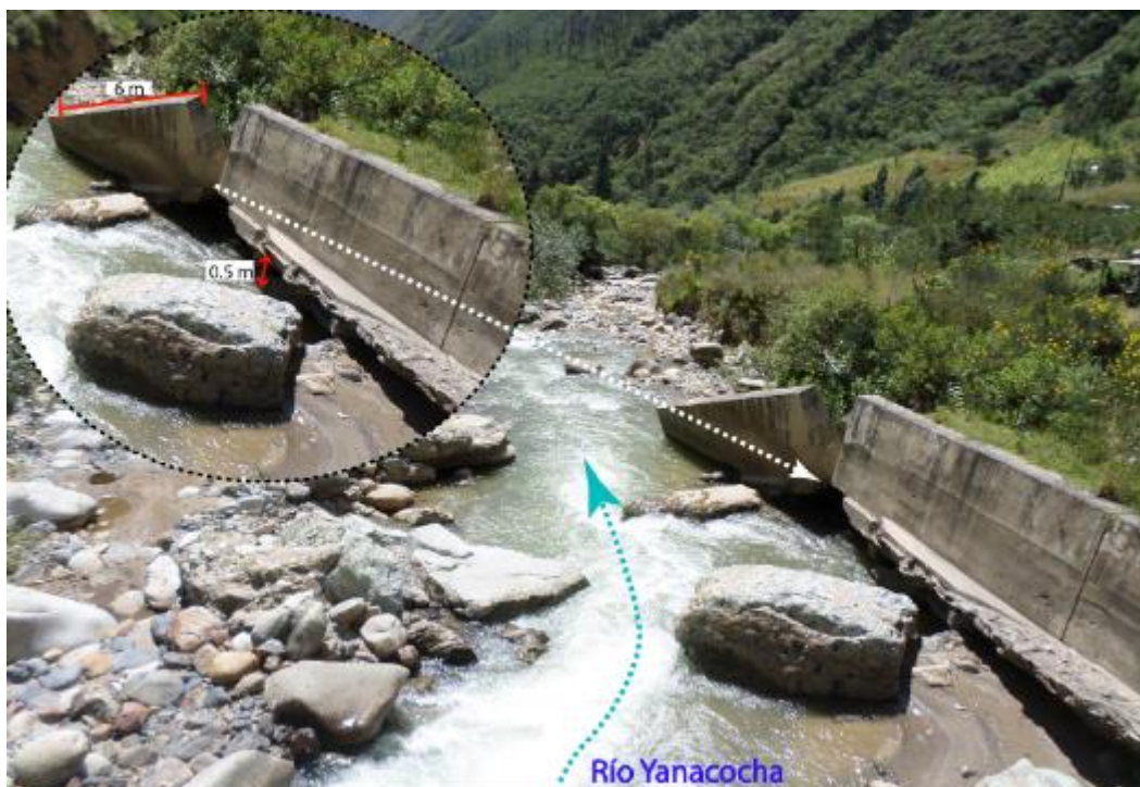
Figura 29. Erosión fluvial, en la base del muro de contención de concreto, socavado 0.5 m, por consecuencia de la pérdida de la estabilidad, colapso de la estructura en 6 m, con coordenadas UTM (WGS 84): 355702.26 E; 8856425.61 N.
