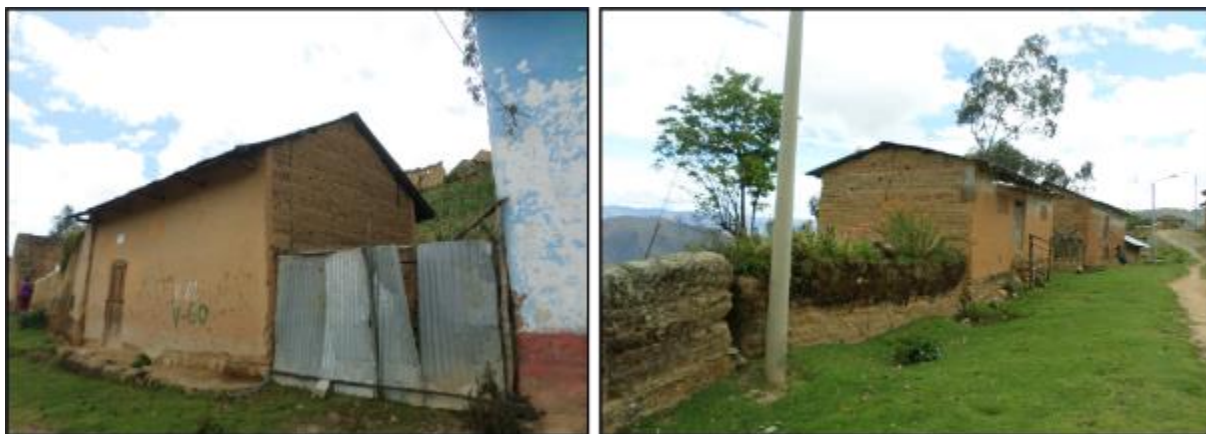
Fotografías 6 y 7. Vista de viviendas de adobe, presentas grietas en sus paredes, producto de los sismos ocurridos en marzo del año 2022, ubicado en el centro poblado de Racray.
