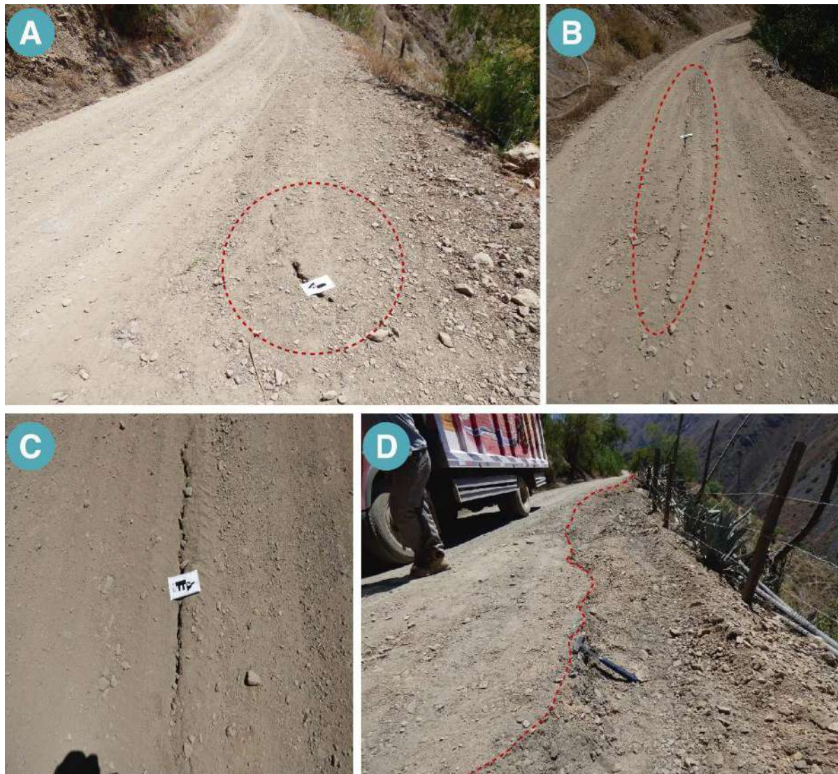
Figura 17. A-C) Grietas en la trocha de acceso entre Churín y Andajes. D muestra colapsos laterales en la trocha carrozable.
