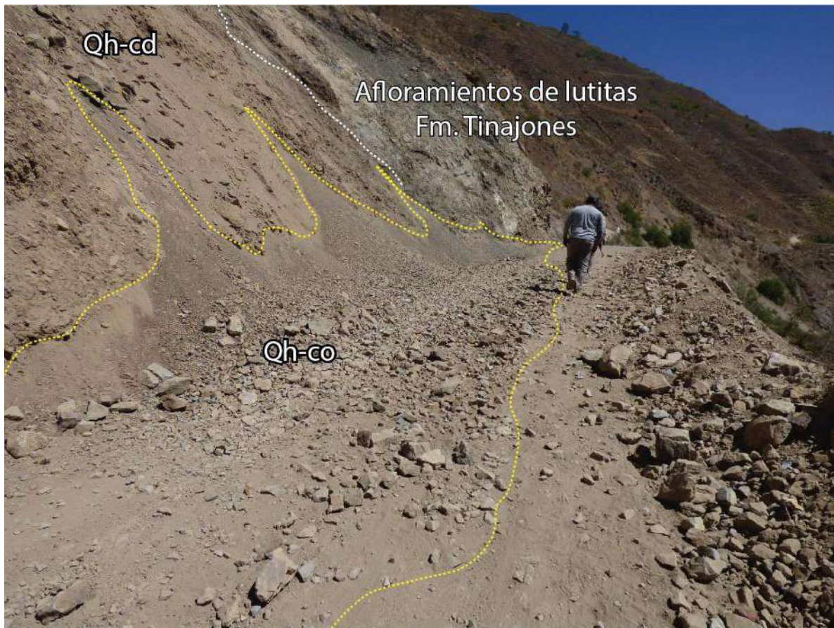
Figura 8. Depósitos coluviales por derrumbes en la ladera este del cerro Yanalpan.
