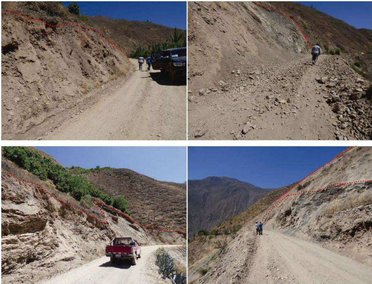
Figura 24. Derrumbes menores (altura <10 m) en los cortes de la trocha de acceso entre Churín y Andajes.
