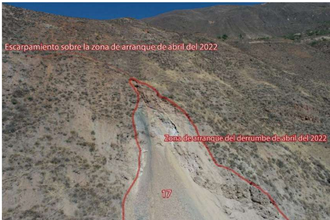
Figura 20. Escarpes y grietas encima de la zona de arranque del derrumbe de abril del 2022.
