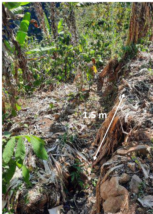
Fotografía 17. Saltos y aperturas cerca a la escarpa del deslizamiento de Ichiquiato Bajo
