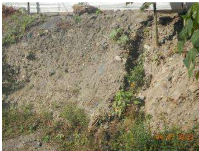
Fotografía 21. Aguas que discurrir sobre la margen derecha del río Talancato
