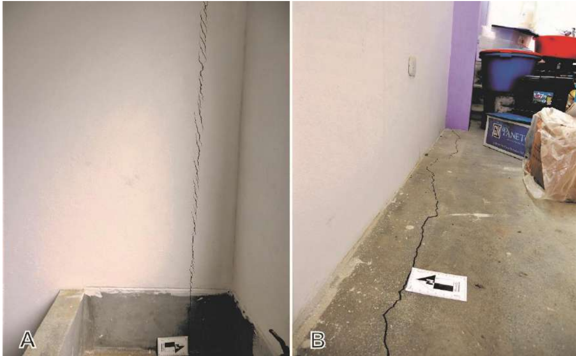
Figura 12. Vista de fisuras en la pared (A) y en el piso (B) de uno de los ambientes de la Institución Educativa N° 80800 .
