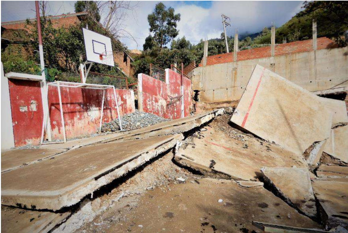
Fotografía 8. Cancha deportiva de concreto afectado por el deslizamiento en el centro poblado de Carhuabamba. Coordenadas UTM: 215511.00 / 9141315.98, Zona 18.
