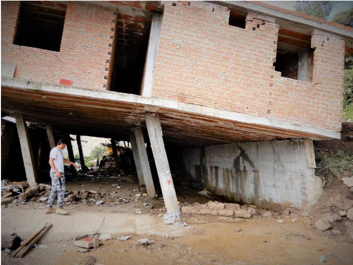
Fotografía 10. Se observa filtraciones de agua en la pared y en el piso de una de las viviendas ubicada sobre la masa deslizada en el centro poblado de Carhuabamba. Coordenadas UTM: 215511.00 / 9141315.98, Zona 18.
