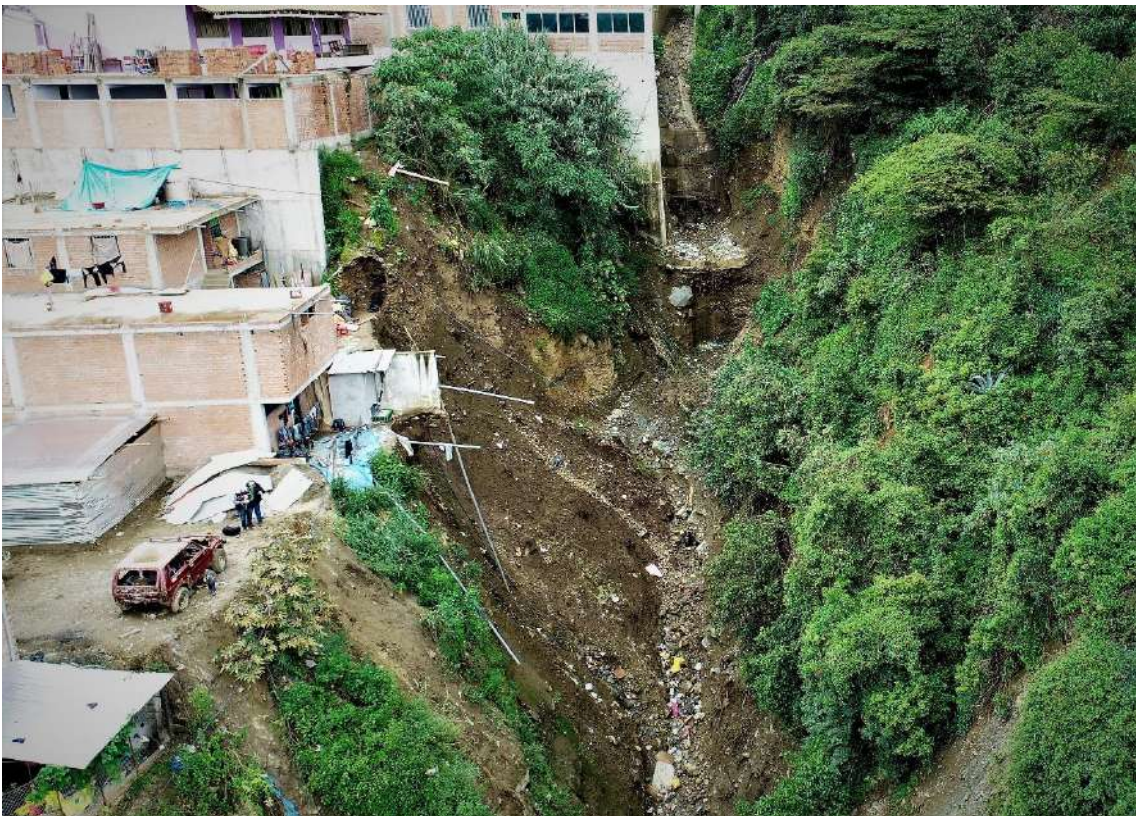
Fotografía 12. Se observa derrumbe en la margen derecha de la quebrada Pueblo Nuevo. Coordenadas UTM: 214813.00 / 9140565.00, Zona 18.
