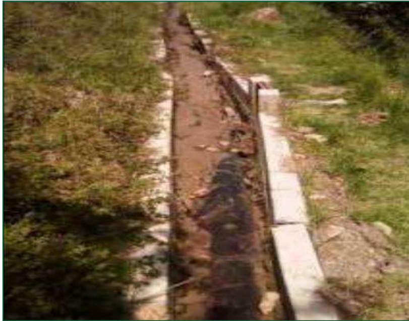
Imagen N° 4: Afectación del canal de riego, presenta grietas
