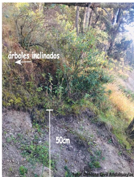
Figura 10. Saltos que evidencian el proceso de activación de un deslizamiento en el sector 3A
