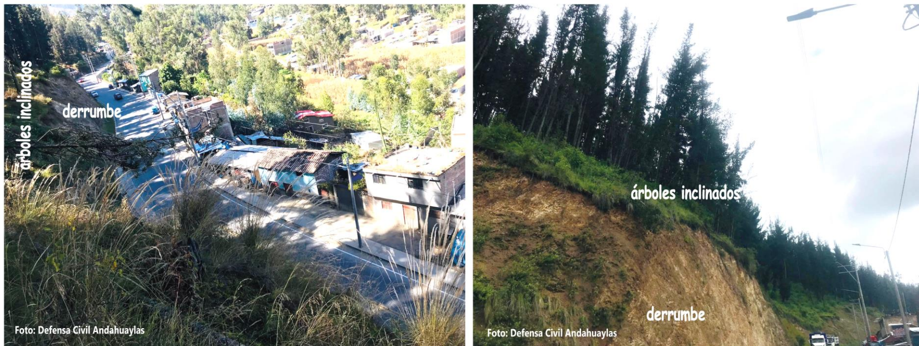
Figura 14. Vista de arboles inclinados, de más de 20 m de altura, en la cabecera del corte de talud de la carretera nacional Andahuaylas a José María Arguedas.
