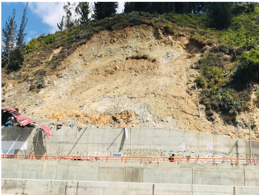
Fotografía 4: Depósito coluvial en el deslizamiento activado en el sector de Pochccota.
