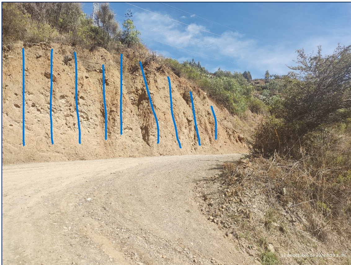
Figura 15: Evidencia de la erosión sobre las vías
