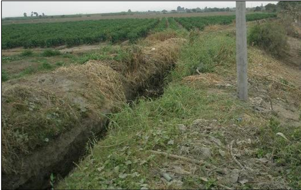
Foto 04: Sector Perla de Macabí, se observa un canal de riego sin revestimiento de concreto.
