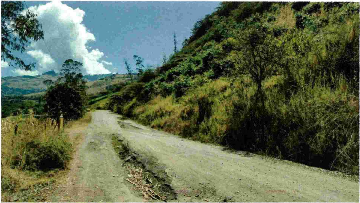
Fotografía 11: Visita Técnica de Campo: Inspección a El Palto, zona de deslizamiento. (17/08/2022)
