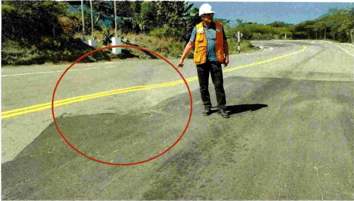
Fotografía 09: Visita Técnica de Campo: Inspección a Kuntur Wasi, se observa deformación de la carretera por deslizamiento. (17/08/2022)
