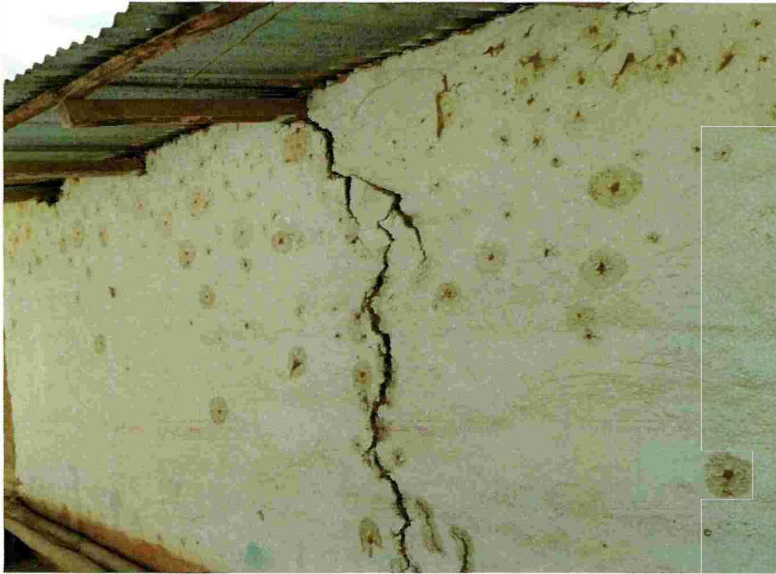
Fotografía 13: Visita Técnica de Campo: Inspección a Jancos, Fallas por deslizamiento en centro educativo. (17/08/2022)
