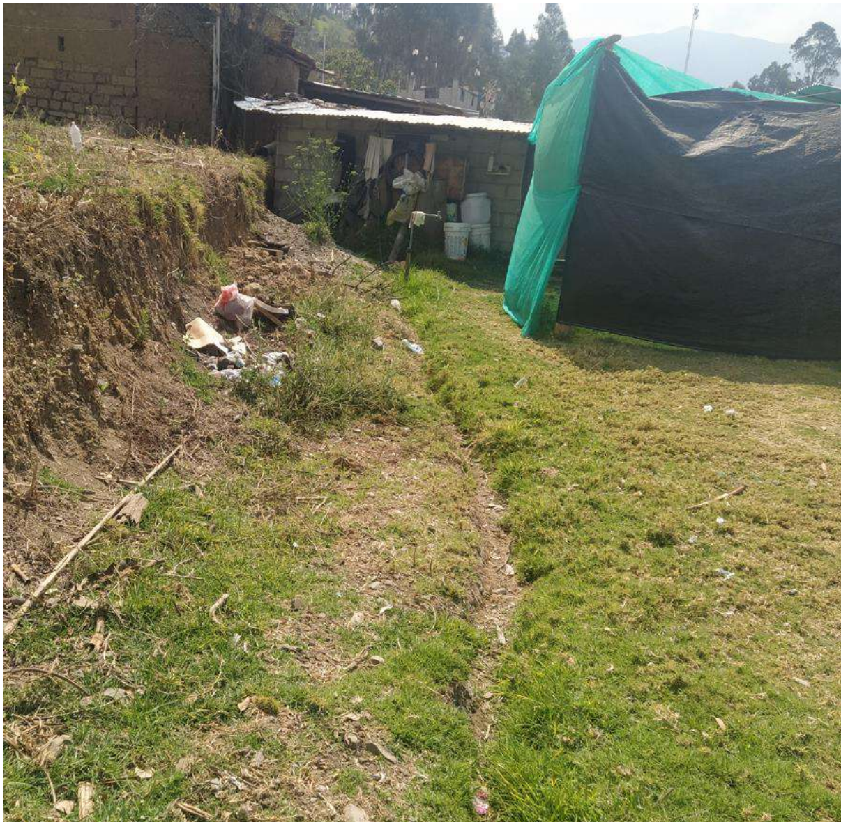
Fotografía 7. Canales de agua y grifos en el sector de Umaccata Baja, sin un adecuado sistema de drenajes que saturan el terreno.
