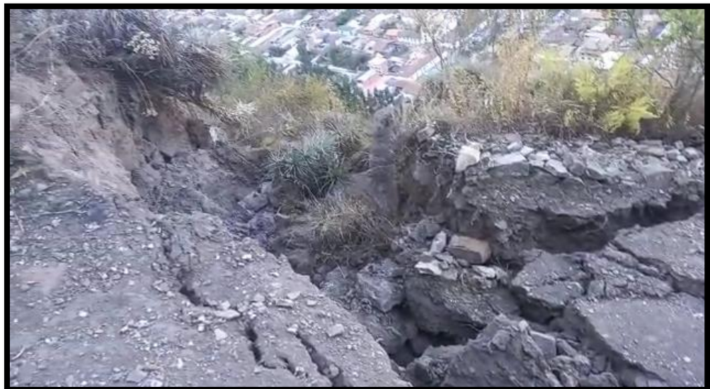
Figura04. Grietas en la parte alta del cerro Cruz de Shallapa donde ocurrió el derrumbe
