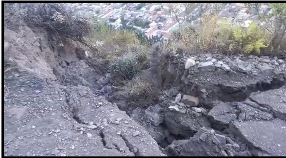
Foto 10. Grietas y rajaduras en la parte alta – zona del mirador
