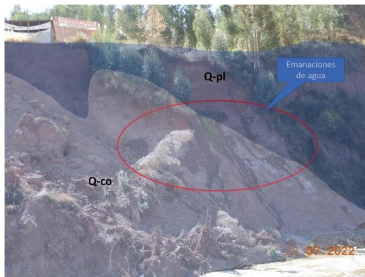
Figura 2. Se aprecia un depósito coluvial adosado a un proluvial con afloramientos de agua en su talud.
