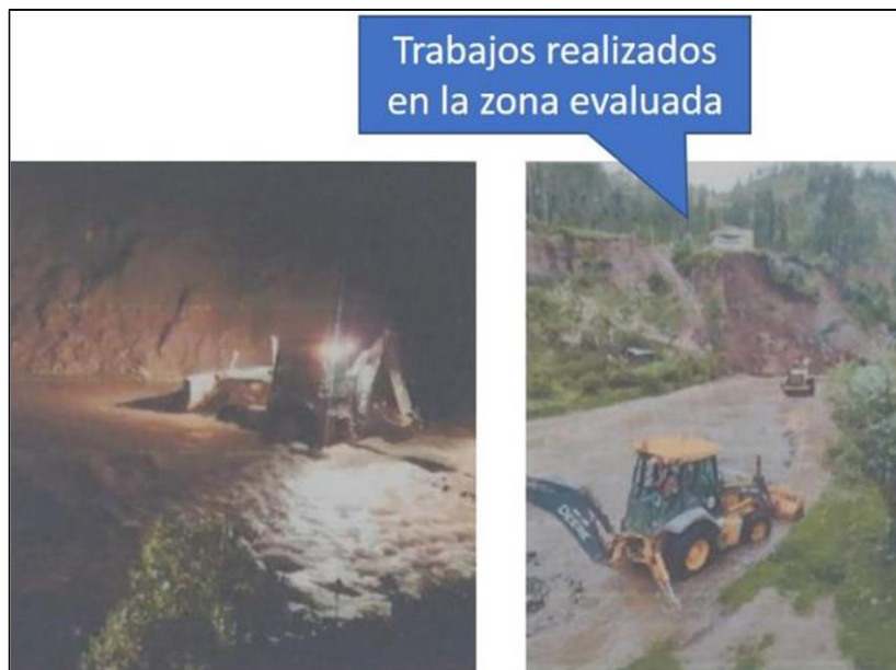
Figura 8. Trabajos realizados en la zona evaluada, fotos extraídas del informe N°015-2022-OGRD-MDS/C de la Municipalidad Distrital de Saylla.
