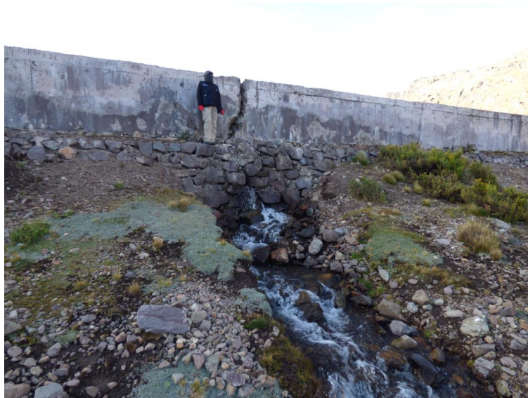
Fotografía 16. Vista frontal de la grieta principal y más crítica del dique.
