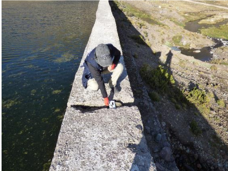
Fotografía 15. Vista de la grieta principal y más crítica del dique en las coordenadas UTM WGS84 357421E-8686237N a 4469 m., de 8 cm a 20 cm de espaciamiento
