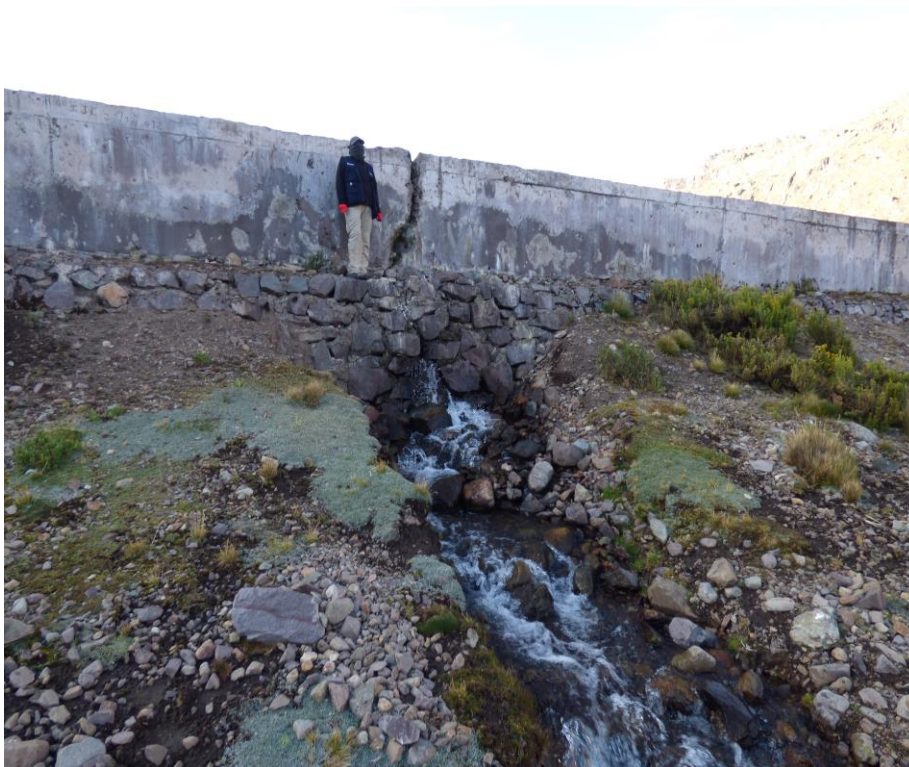
Fotografía 12. Depósito de un huaico con ancho de cauce de 6 a 10 m de ancho, sobre este depósito se construyó una parte del dique de la represa Tuctococha que presenta agrietamiento de más de 20 cm de separación, en las coordenadas UTM GWS84 357321E, 8686311N.
