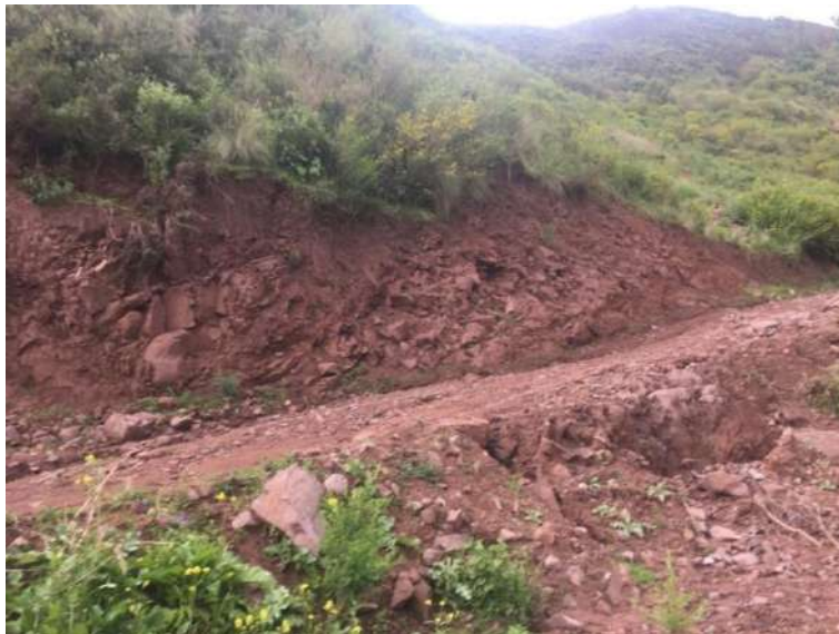
Formación de escarpas por corte de ladera
