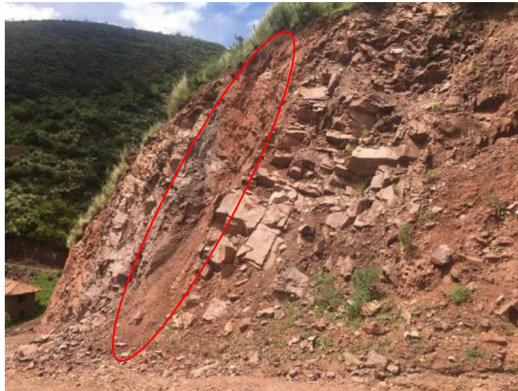
Intercalaciones de lutitas y areniscas de la formación Chilca Talud de la vía local
