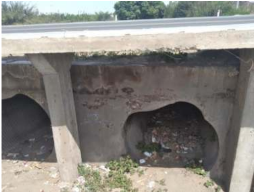
Alcantarillas con poca dimensión por donde pararía las aguas hacia la parte baja zona agrícola
