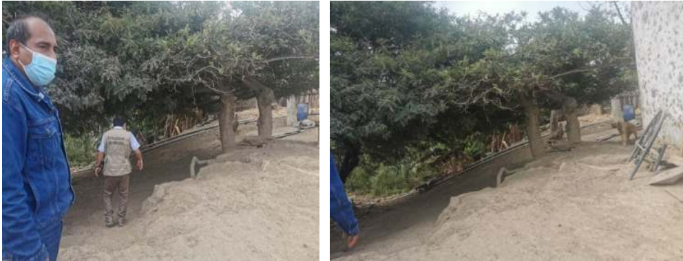
Margen Izquierda del Río Zaña, erosionada en épocas de grandes avenidas de agua, requiere formación y reforzamiento de ribera margen izquierda del río
