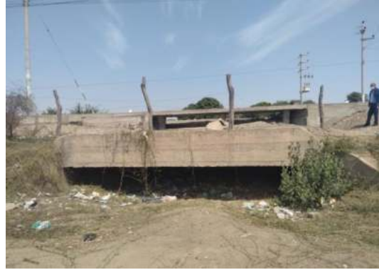
Pontón colmatado con sedimentos por donde pasan las aguas
