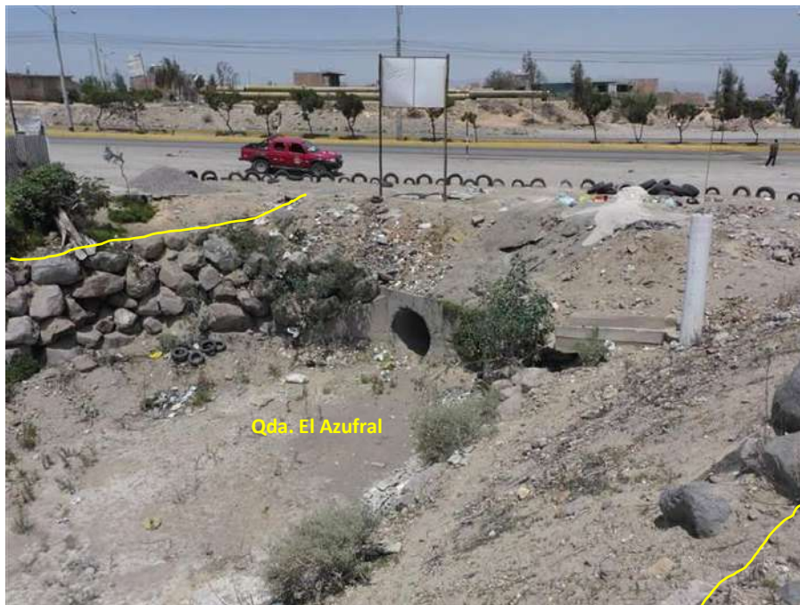
Figura 41. Cruce afirmado (punto crítico) en la quebrada El Azufra, alcantarillas o pontones parcialmente cubiertos por basura (Coordenadas UTM WGS84 225080 E, 8193159 N).
