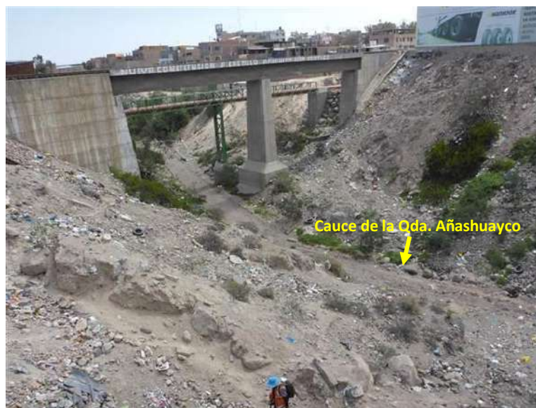
Figura 45. Puente Añashuayco (Punto crítico) con depósito de desmonte y basura en las laderas y lahares recientes en el cauce (Coordenadas UTM WGS84 223480 E, 8191634 N).
