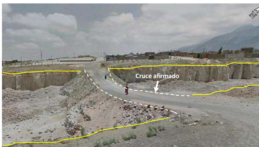
Figura 500. Punto crítico: Cruce afirmado construido sobre material de desmonte y relleno (Coordenadas UTM WGS84 222628 E, 8191407 N).
