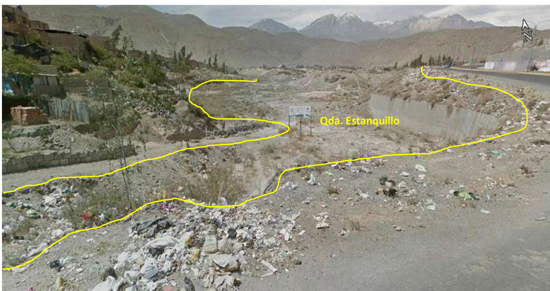
Figura 43. Cruce afirmado, observándose cerca al cauce viviendas prefabricadas y material de desmonte, quebrada Estanquillo (Coordenadas UTM WGS84 223655 E, 8193226 N).
