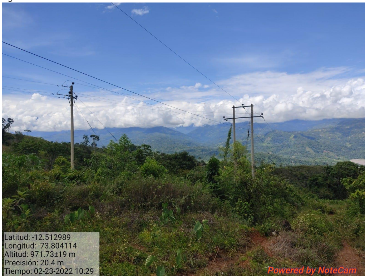
Fotografía N° 3. Postes de alta tensión ubicados en el ámbito de la comunidad la libertad.
