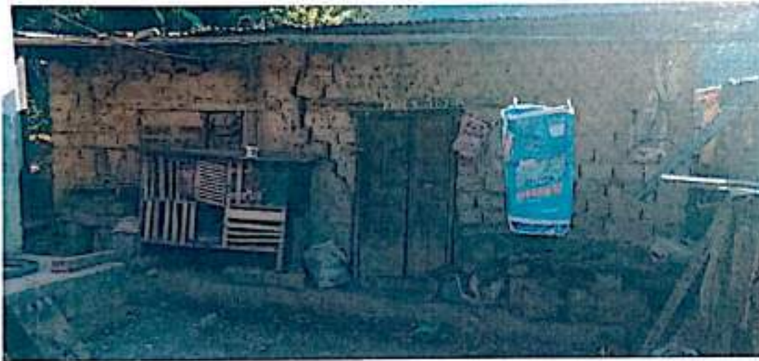
Ilustración 31. Sector de Limonpata, vista de agrietamientos de vivienda producto de la inestabilidad del terreno en que se edifican estas estructuras.
