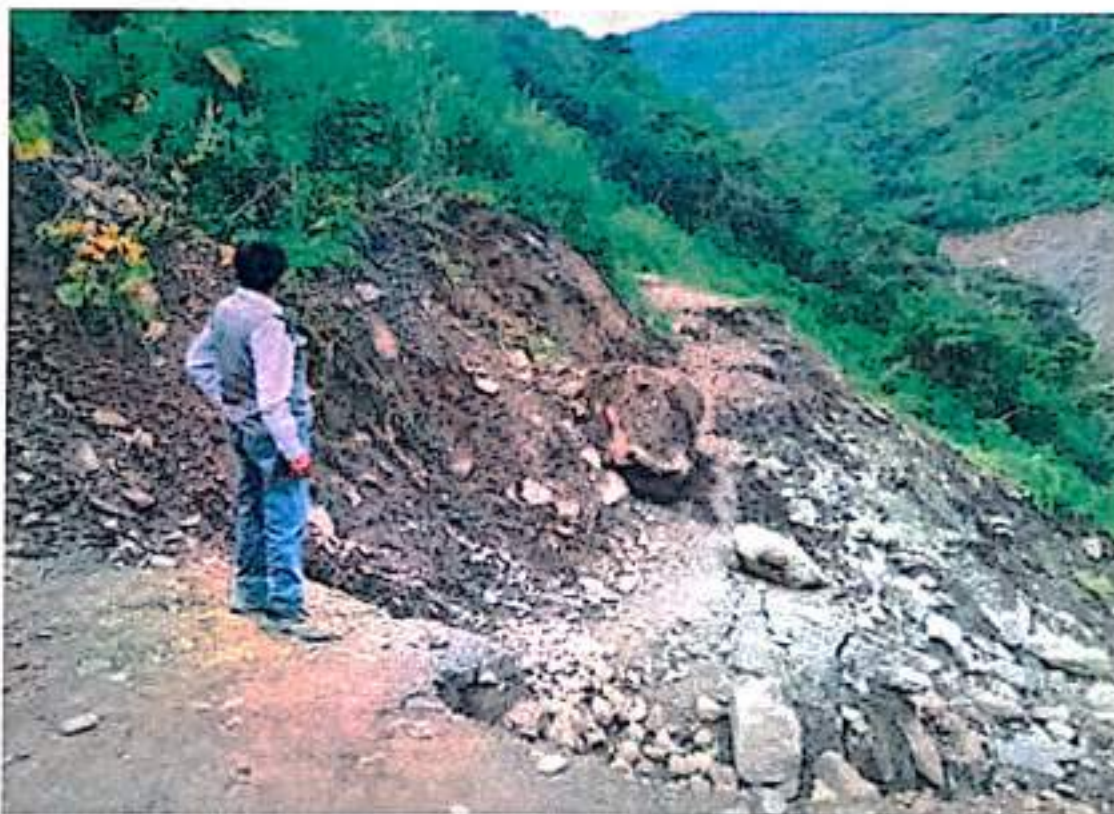
Ilustración 28. pérdida de plataforma carrozable, por deslizamiento en el sector de Cochapampa
