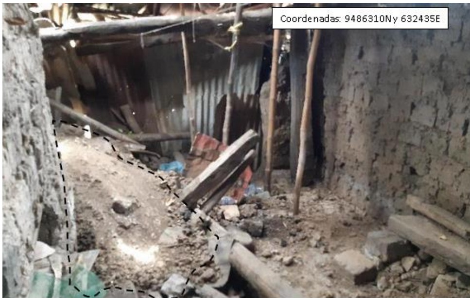
Figura 29. Vivienda afectada por deslizamientos y flujos en el caserío Sicacate.
