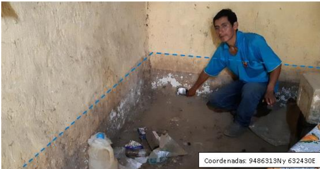
Figura 30. Nivel del material deslizado que ingresó a la vivienda en el caserío Sicacate.
