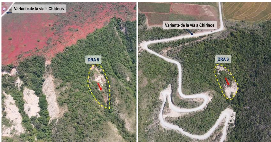
Figura 22. Vista de dos deslizamientos rotacionales de menor amplitud en el caserío Cunía
