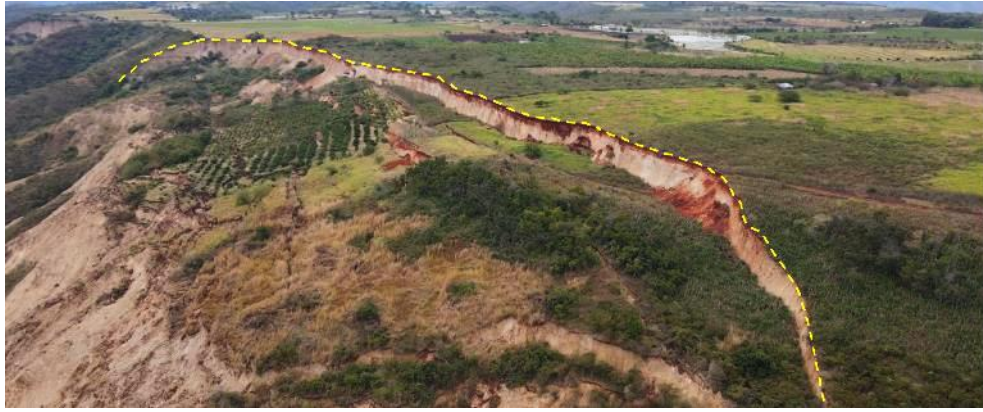
Figura 19. Vista del escarpe del deslizamiento DRA 2 el 08/07/2021.
