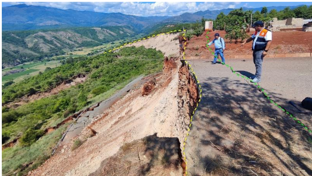
Figura 16. Parte alta del deslizamiento Cunía, donde se aprecia el escarpe principal (en amarillo) y grietas de tracción detrás de la corona (en verde).
