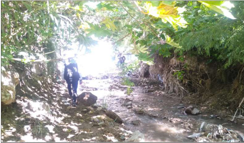
FIGURA N°01: TRAMO CRÍTICO EN LA QUEBRADA HUICHCCANA, DONDE SE APRECIA LA EROSION POR EL FLUJO DE LA QUEBRADA
