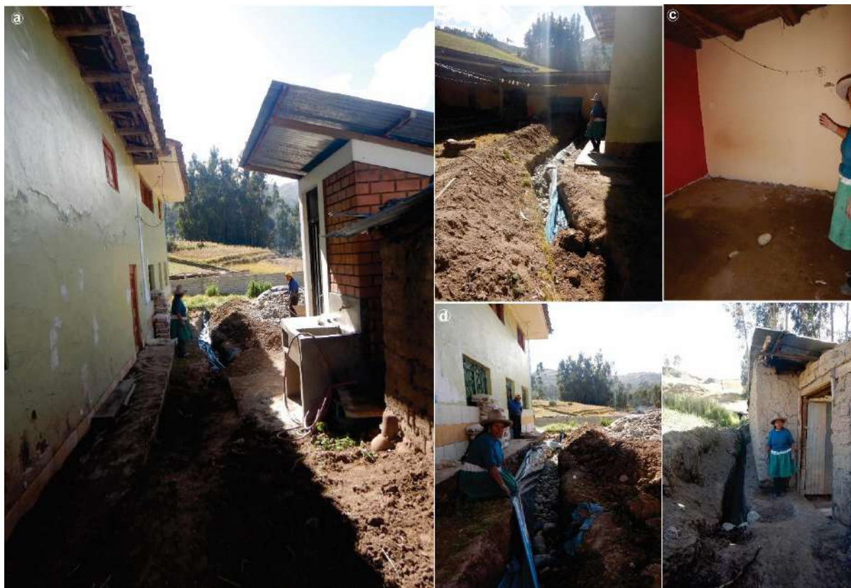
Figura 31. Vivienda afectada, realiza zanjas en casi todo el alrededor; como medida de correctiva, para evitar la inundación y generar humedad.
