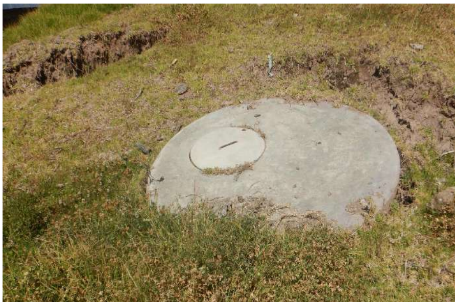
Figura 27. Buzón del desagüe afectado por el deslizamiento; actualmente en desuso.
