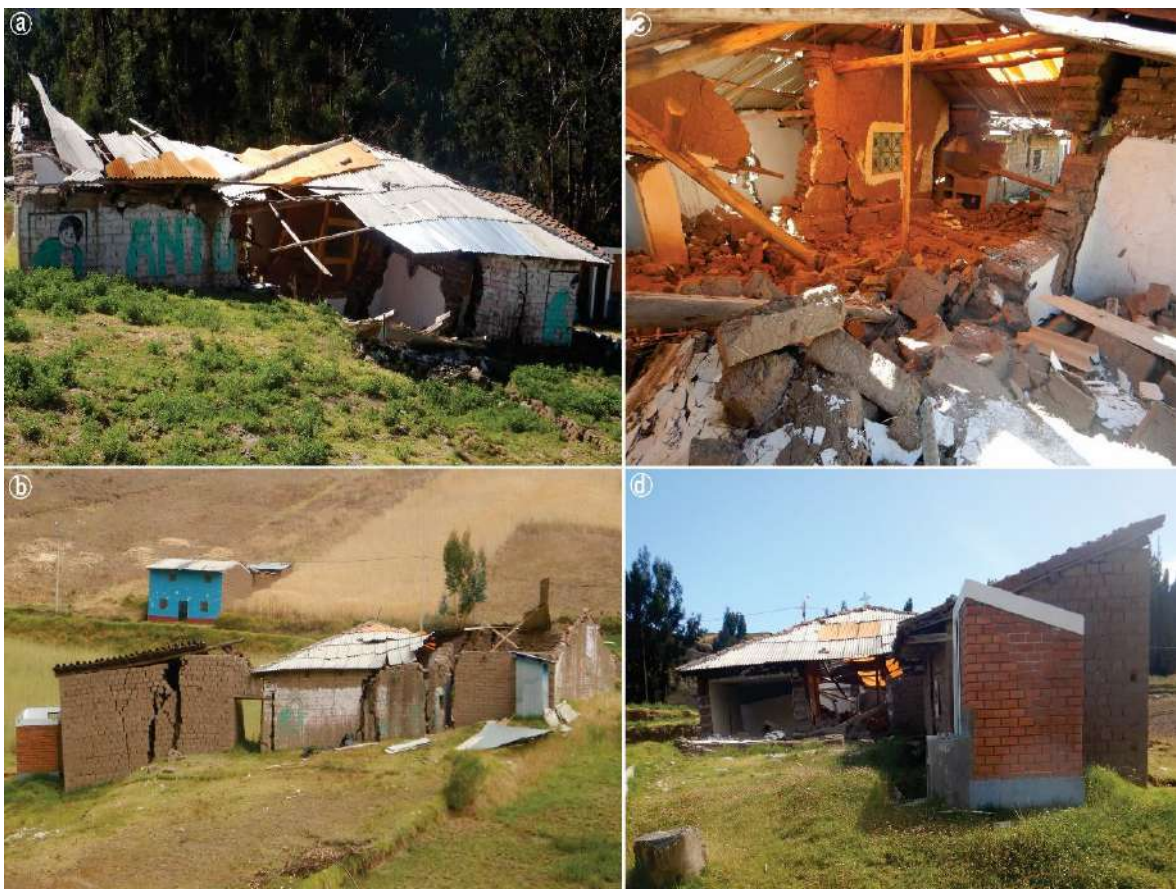
Figura 26. Vista de distintos ángulos de la vivienda destruida, por el deslizamiento; cabe mencionar que la escarpa cruza por medio de la vivienda.
