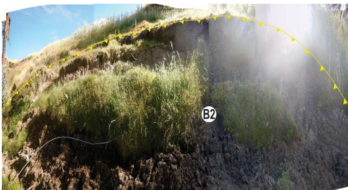
Figura 30. Vista de la escarpa del deslizamiento (B2), se observa emanación de agua subterránea.
