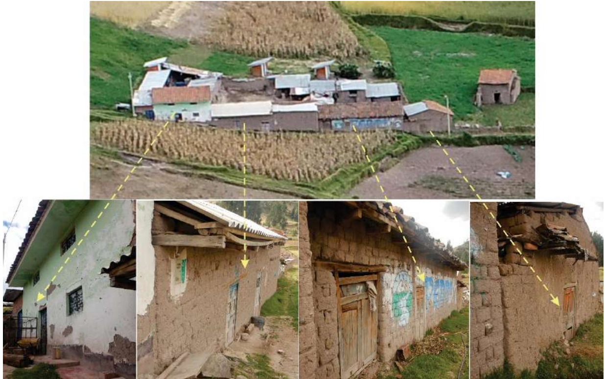
Figura 32. Viviendas que presentan agrietamientos en sus paredes.
