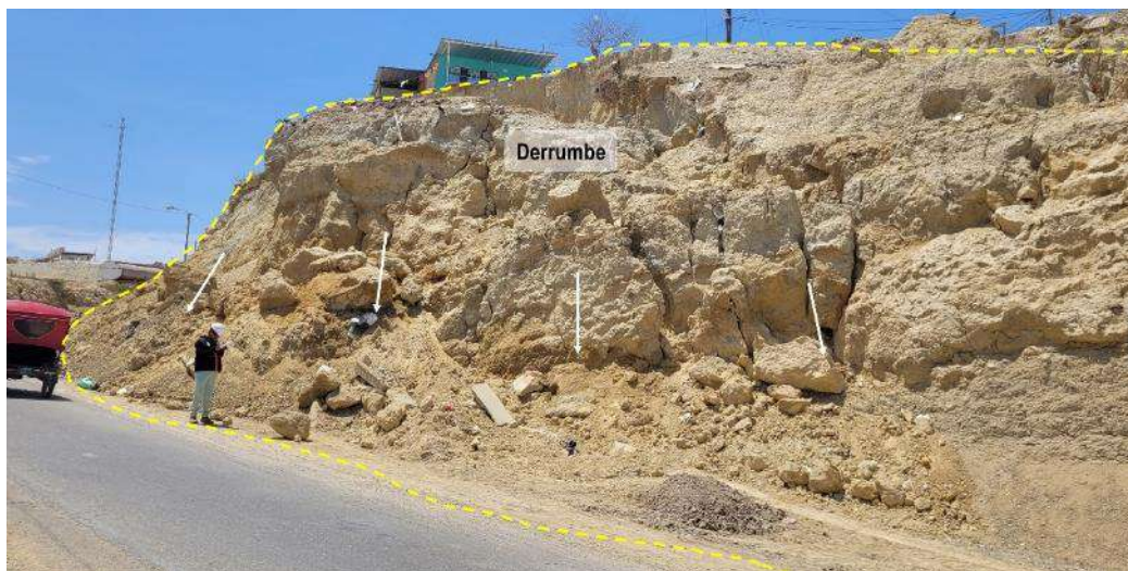
Figura 17. Vista a un derrumbe en el AH Vista al Mar que ha afectado a una vivienda y a la vía.
