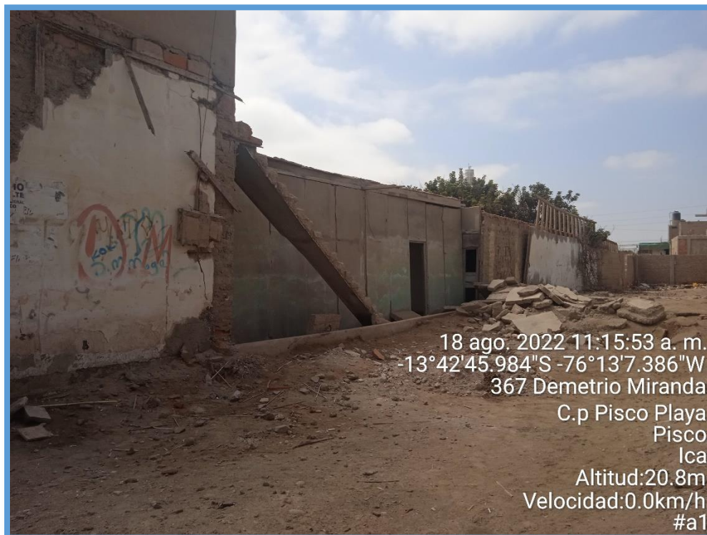
Figura 10: Daños en las viviendas ocasionados en el sismo del 2007
