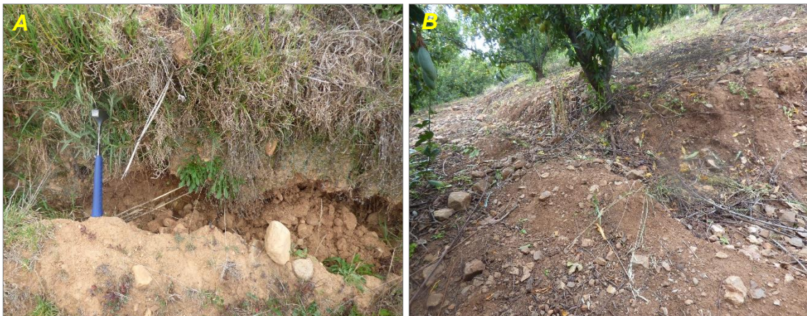
Figura 11. A) Canal de riego situado por encima de la corona del deslizamiento del cerro Wishcana. B) Canal de riego situado en el cuerpo del derrumbe de Independencia.
