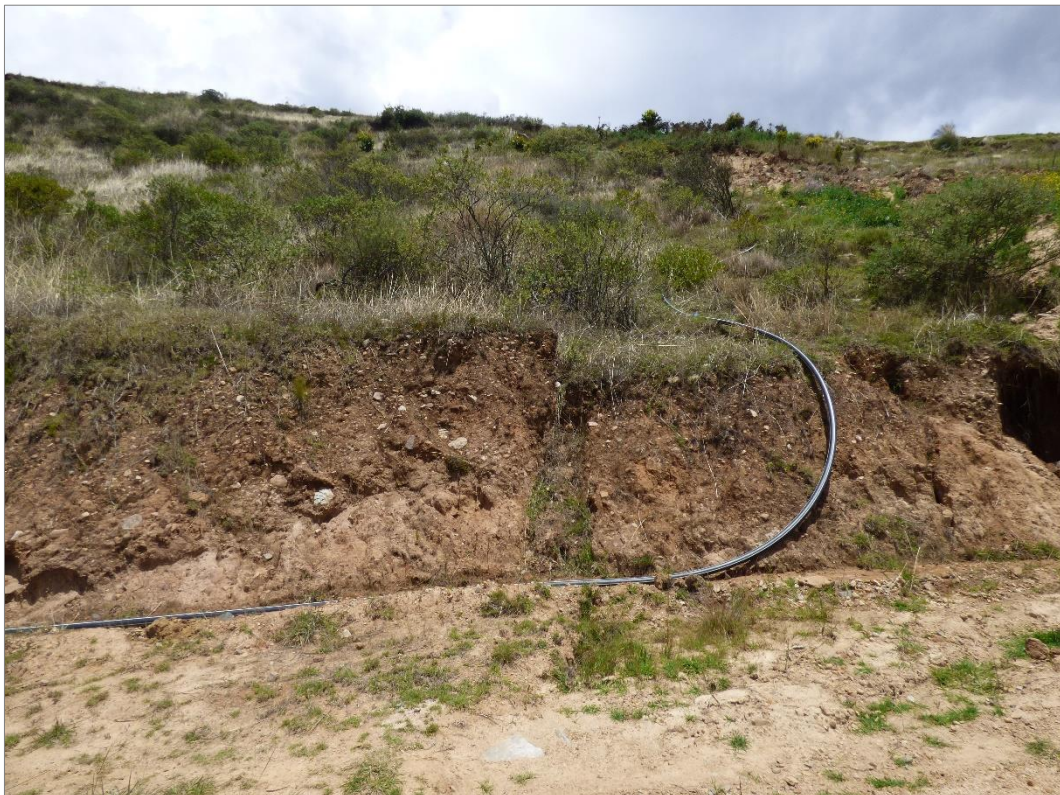
Fotografía 6. Desplazamiento del terreno, en dos bloques, producto de la dinámica del evento, el cual afectó tramo carretero en 100 m aproximadamente.
