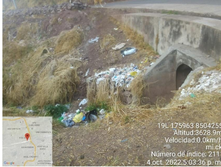
Fotografía 27: cauce natural con presencia de residuos
