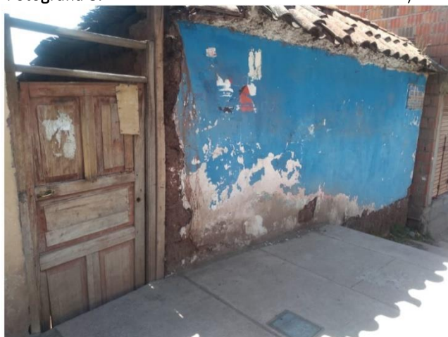
Fotografía 8: Vivienda en estado de conservación muy malo
