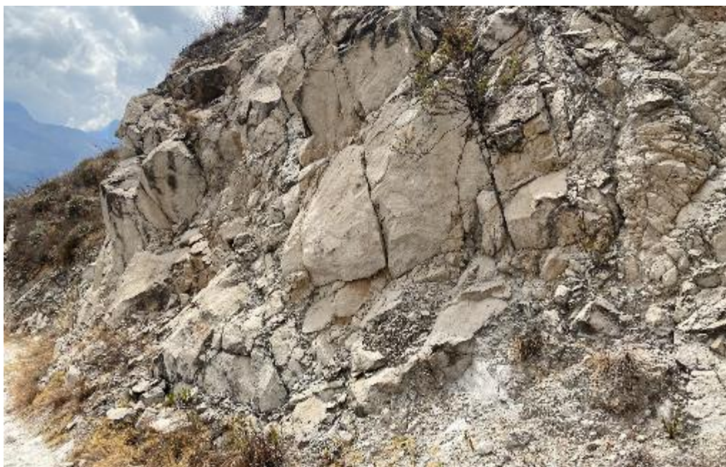
Fotografía 12. Corte de talud realizado para la trocha carrozable, se observan un fracturamiento principal con dirección S56E. Coordenadas referenciales: UTM WGS84 Zona 18S 192064 E, 8999851 N.
