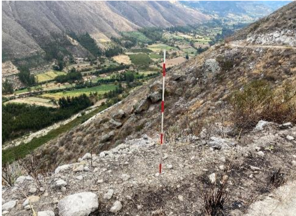
Fotografía 14. Material suelto en las laderas del Cerro San Juan, que ante lluvia o sismos pueden desestabilizar y afectar la parte baja. Coordenadas referenciales: UTM WGS84 Zona 18S 191714 E, 8999748 N.
