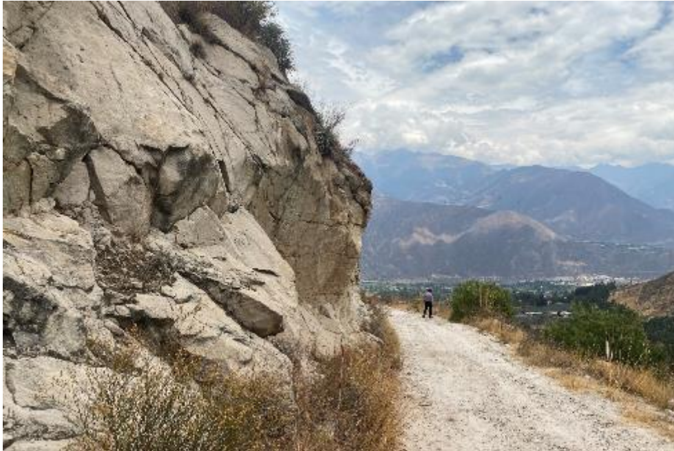
Fotografía 9. Trocha carrozable que conduce hacia el Mirador del Cerro San Juan. Se observa el grado de fracturamiento de la roca, como también la formación de cuñas. Coordenadas referenciales: UTM WGS84 Zona 18S 192173 E, 8999891 N.
