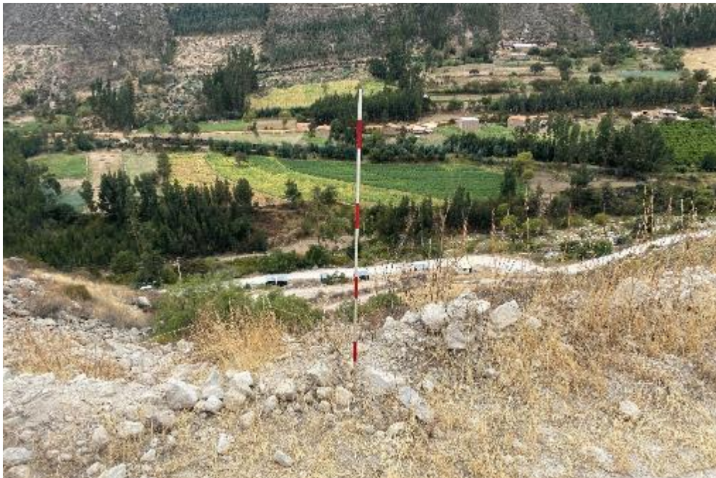
Fotografía 10. Bolos y cantos sueltos, que en tiempos de lluvia pueden ceder cuesta abajo y podrían afectar las viviendas que se encuentran cuesta abajo. Coordenadas referenciales: UTM WGS84 Zona 18S 192077 E, 8999924 N.
