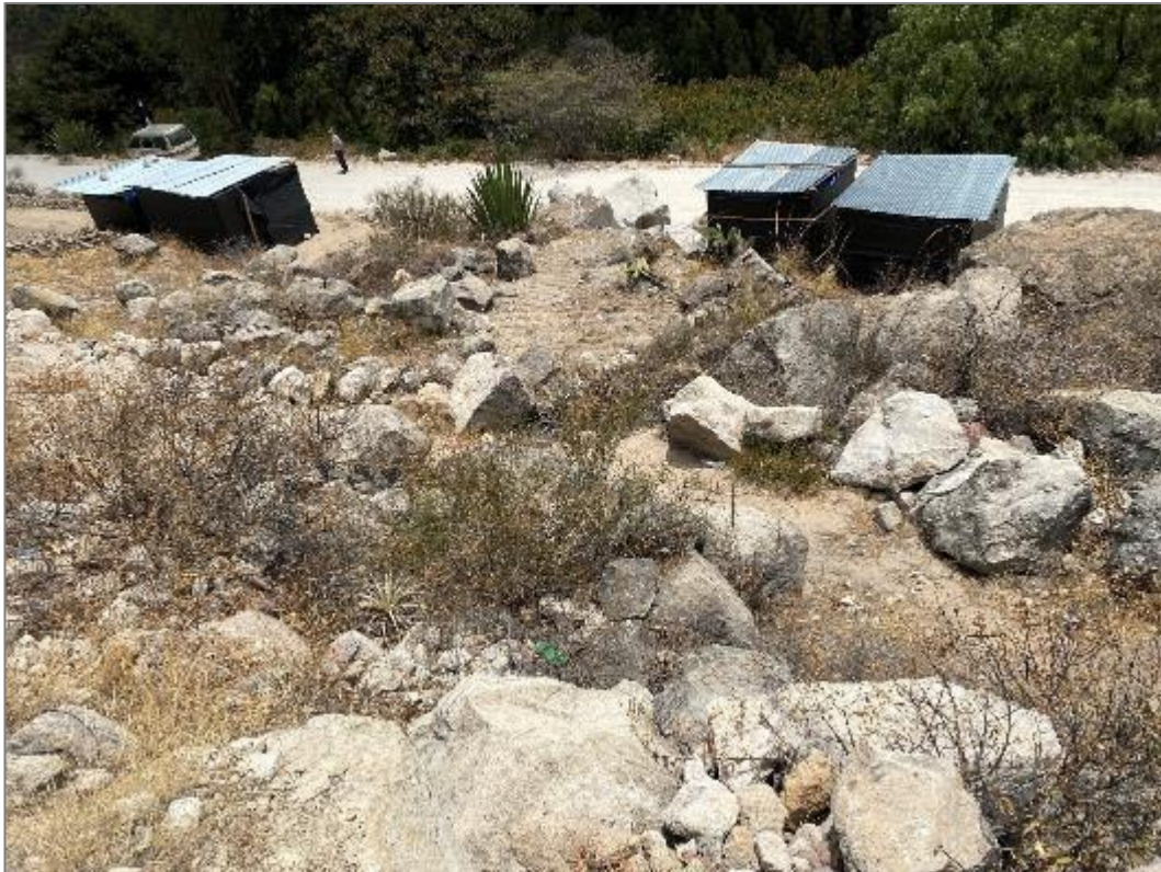
Fotografía 8. Ladera con fragmentos de rocas sueltas, aledaña al trazo de la trocha carrozable hacia el mirador del Cerro San Juan. Coordenadas referenciales: UTM WGS84 Zona 18S 192059 E, 9000033 N.
