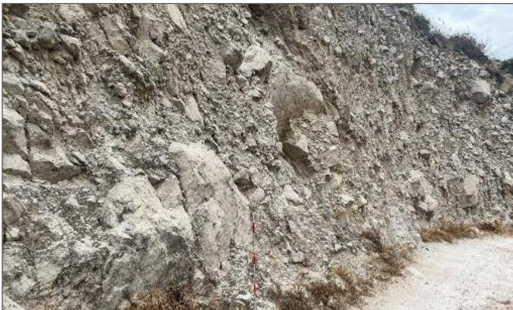
Fotografía 11. Tobas blanquecinas meteorizadas que, ante lluvias intensas o movimientos sísmicos, podrían generar derrumbes o caída de rocas. Coordenadas referenciales: UTM WGS84 Zona 18S 191996 E, 8999916 N.
