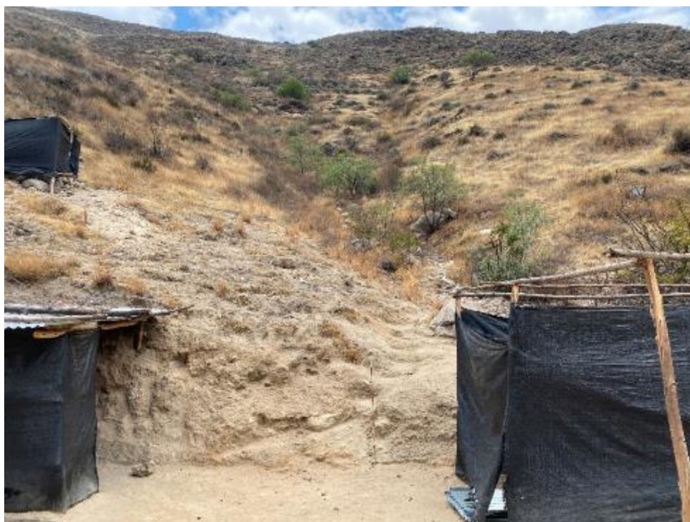
Fotografía 13. Vista de casas rústicas, asentadas sobre el cauce de una quebrada insipiente con procesos de erosiones en cárcavas, que podrían activarse en temporada de lluvias intensas, lo cual afectaría a dichas viviendas. Coordenadas referenciales: UTM WGS84 Zona 18S 191787 E, 8999990 N.
