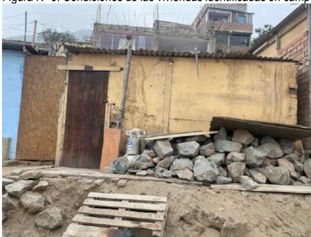
Figura N° 8: Condiciones de las viviendas identificadas en campo
