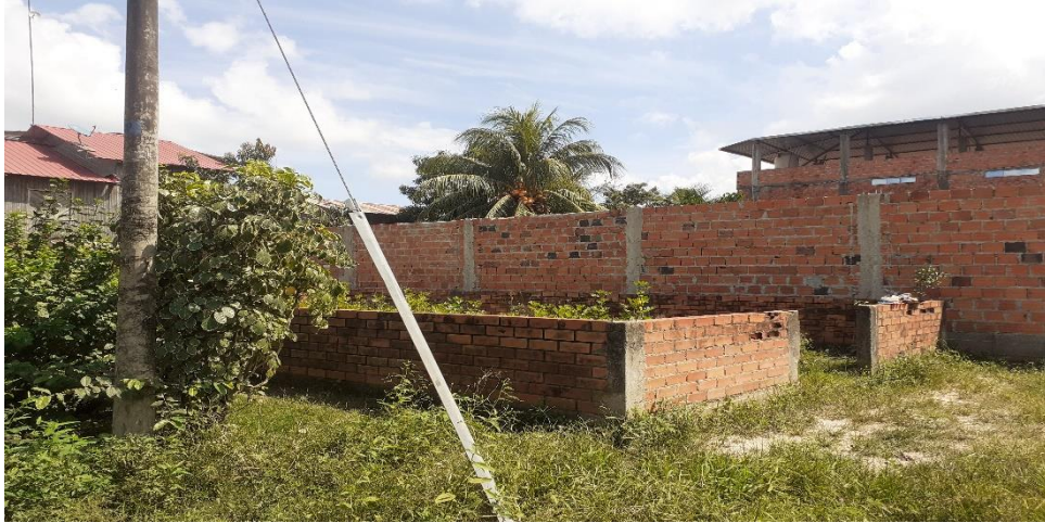
Foto N° 1: Casa abandonada con paredes de concreto.
