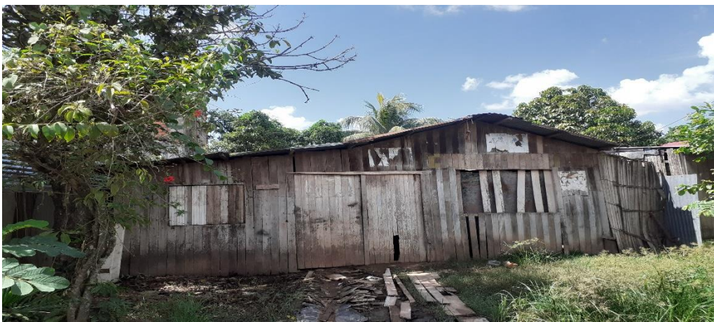
Foto N° 4: casa de un piso con techo de calamina y paredes de madera.
