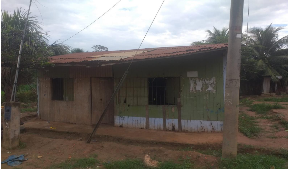
Foto N° 23: casa de un piso con techo de calamina y paredes de madera.
