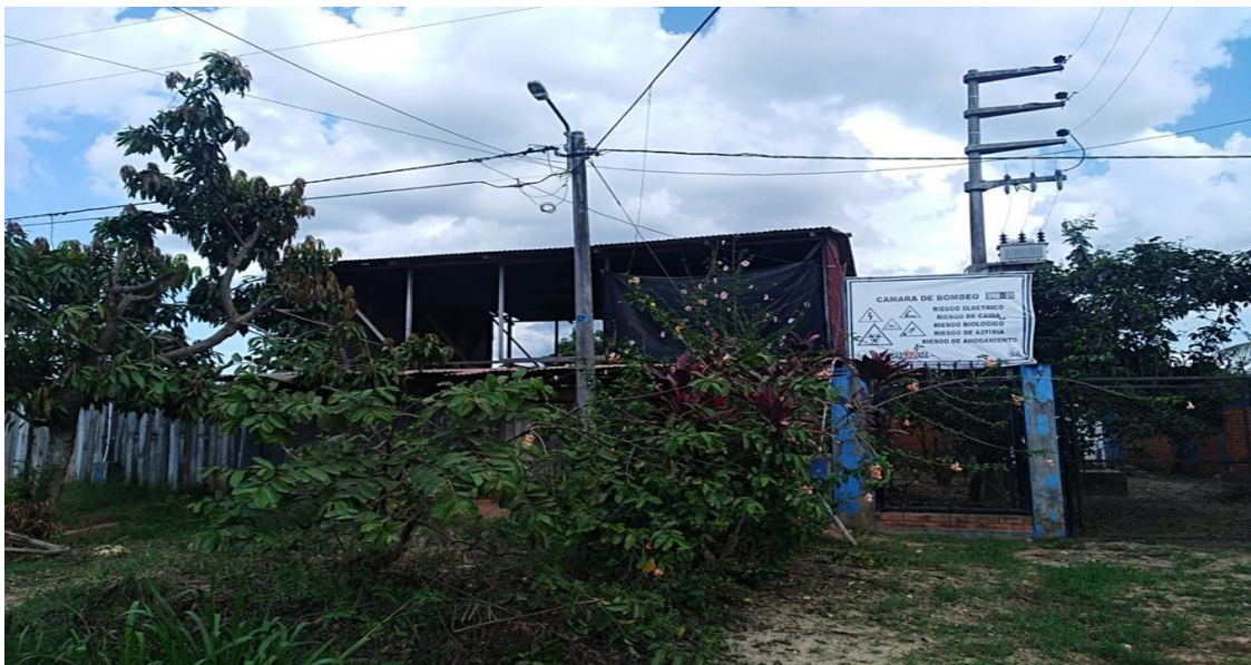
Foto N° 34: casa de dos pisos en construcción de madera con techo de calaminas.
