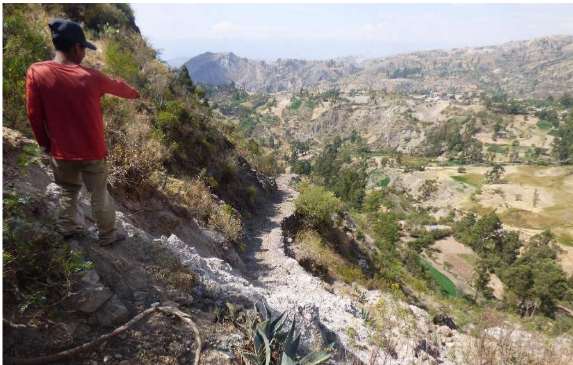
Fotografía 5. Vestigios del camino en el cuerpo del deslizamiento los cuales registran desplazamientos de hasta 10 m ladera abajo.
