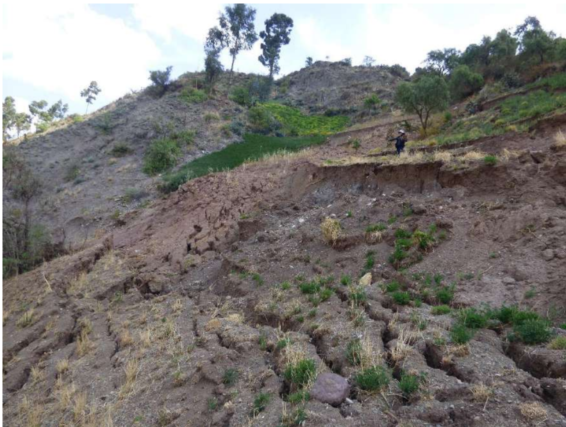
Fotografía 4. Vista de la superficie del terreno bastante agrietada, con longitudes variables de 5 a 20 m y aperturas de hasta 20 cm.
