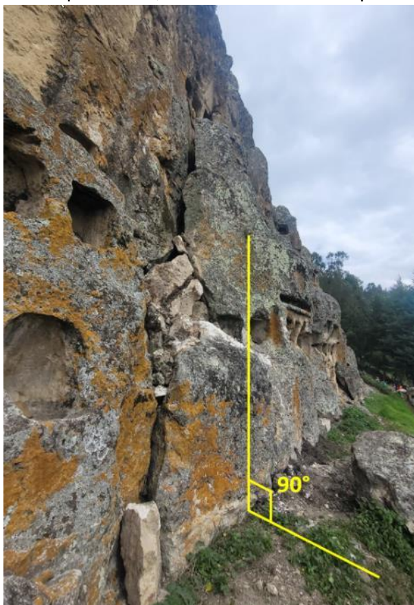
Figura 6. Los nichos funerarios están construidos sobre un macizo rocoso con una pendiente con una pendiente < 45^\circ , en donde se origina la caída de rocas.
