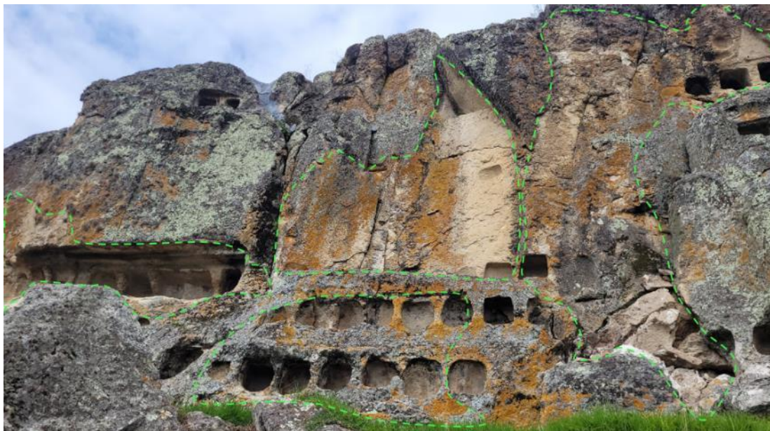
Figura 18. Delimitada con líneas discontinuas de color verde se observa las áreas moderadamente hasta altamente meteorizadas. Se ubica en el lado derecho del frontis de las Ventanillas de Otuzco.
