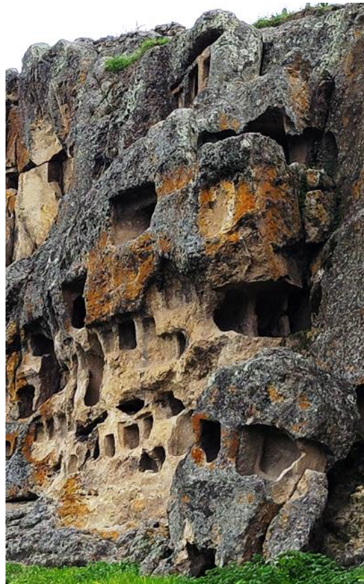
Fotografía 8. Detalle de la zona del Perfil D-D', donde se observa una gran densidad de nichos funerarios excavados en la cara del talud, cavidades que han contribuido a la alta inestabilidad del mismo talud.
