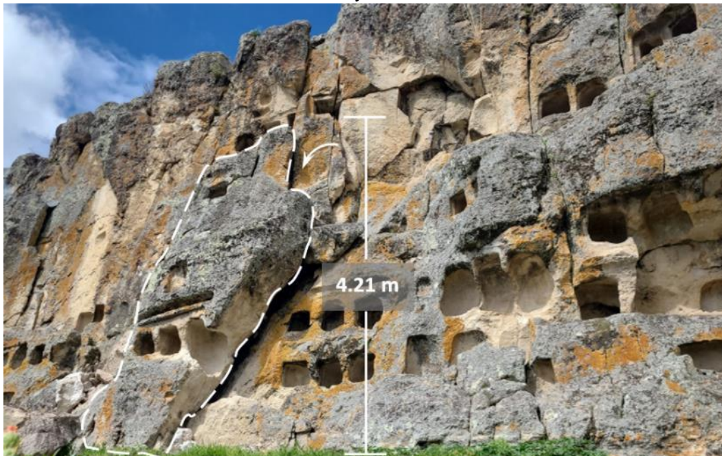
Figura 11. Se observa el bloque que ha colapsado (línea blanca discontinua), parte central del frontis donde se ubican los nichos fúnebres. Coordenadas UTM WGS84, Norte: 9211580 – Este: 780799.
