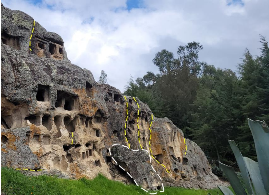
Figura 17. Se observa bloque caído (líneas blancas discontinuas) y las fracturas (líneas amarillas discontinuas) del macizo, ubicadas en el lado izquierdo del frontis de las Ventanillas de Otuzco.
