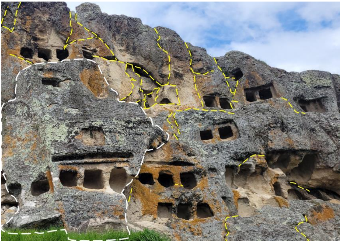
Figura 16. Se observa bloque caído (líneas blancas discontinuas) y las fracturas (líneas amarillas discontinuas) del macizo, ubicadas en el centro del frontis de las Ventanillas de Otuzco.
