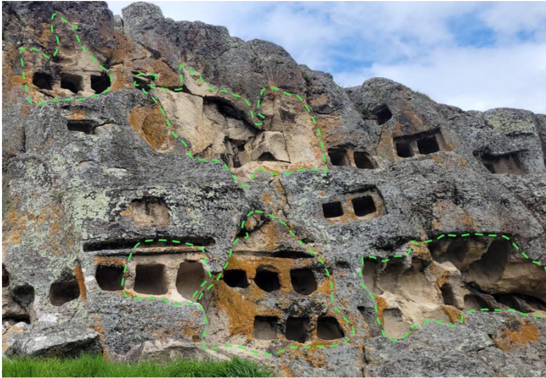
Figura 19. Rocas de moderadamente hasta altamente meteorizadas, con erosión pluvial y eólica en el centro del frontis de las Ventanillas de Otuzco, dentro de las líneas discontinuas de color verde.
