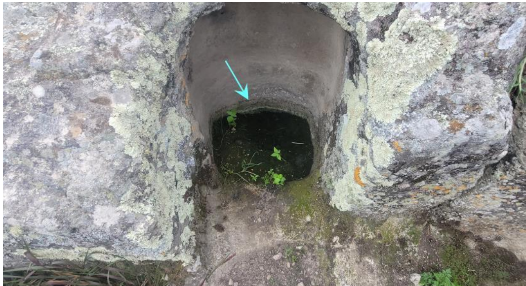
Figura 24. En las depresiones originadas por los nichos deteriorados, se observa el anegamiento de agua, la cual filtra y deteriora los nichos fúnebres ubicados en la parte frontal.
