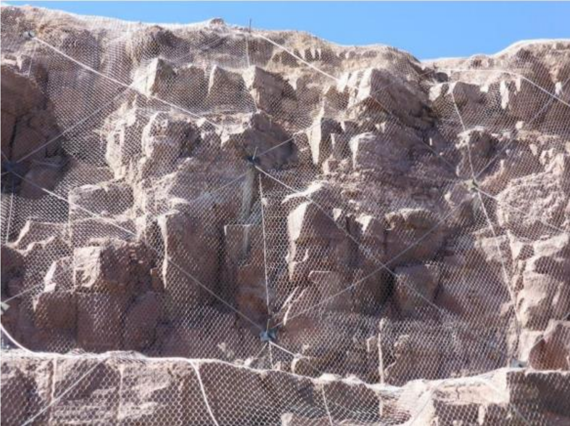
Figura A1. Control de caída de rocas utilizando mallas ancladas.
