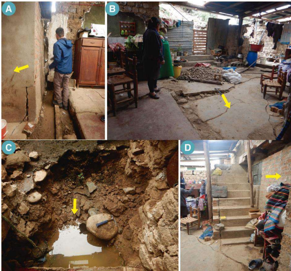
Figura 20. Muestra los daños en la vivienda n° 1 por el deslizamiento D4, las flechas amarillas señalan la dirección del movimiento perpendicular a la pendiente. A y D, muestran aperturas en la base del primer piso lo que hace a la construcción altamente susceptible a colapsar por agrietamientos de hasta
