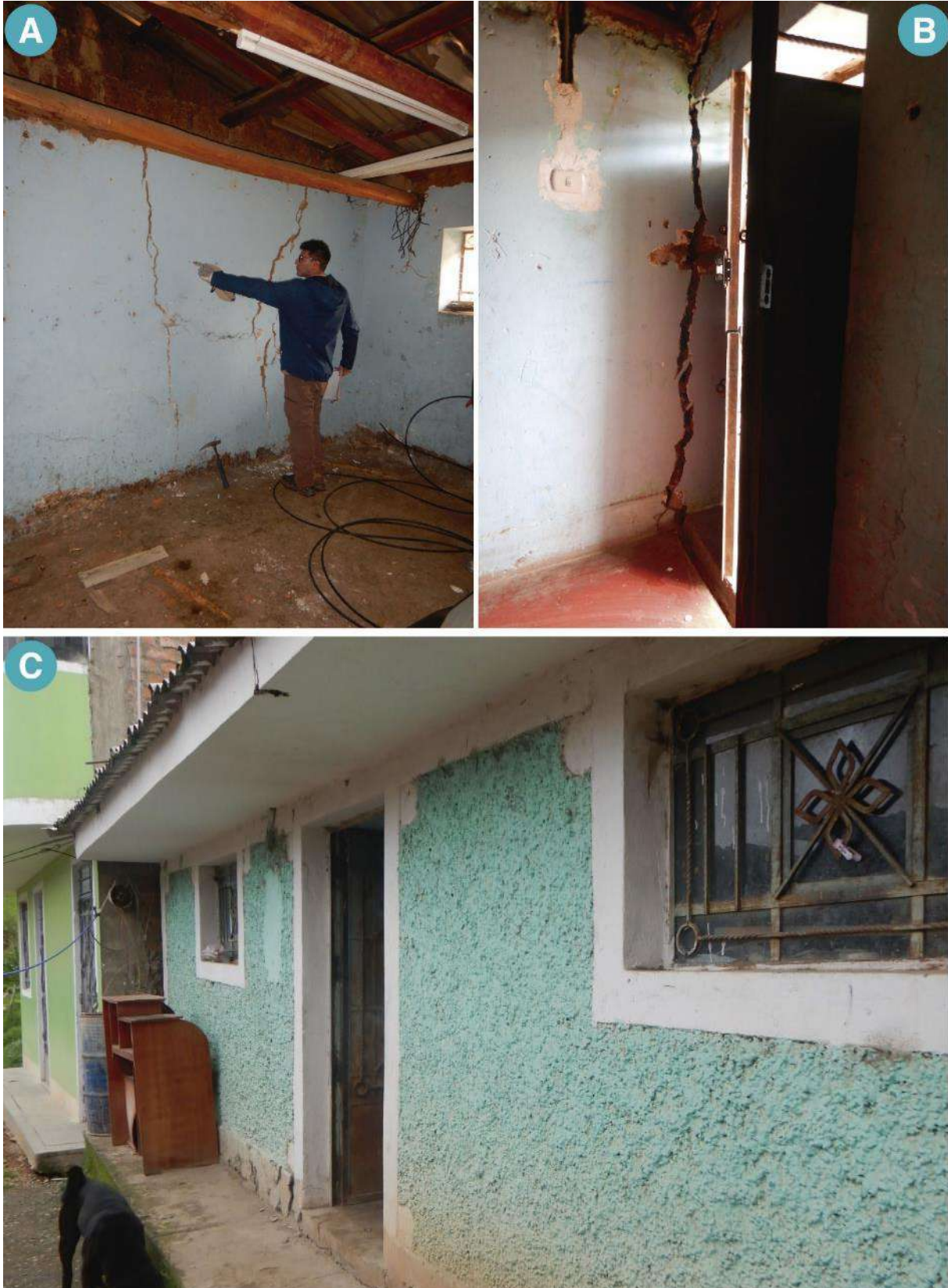
Figura 23. Muestra los daños en la vivienda n° 5 por el deslizamiento D4, A y B, muestran los agrietamientos en la vivienda, mientras que C) muestra la fachada de la vivienda actualmente abandonada.
