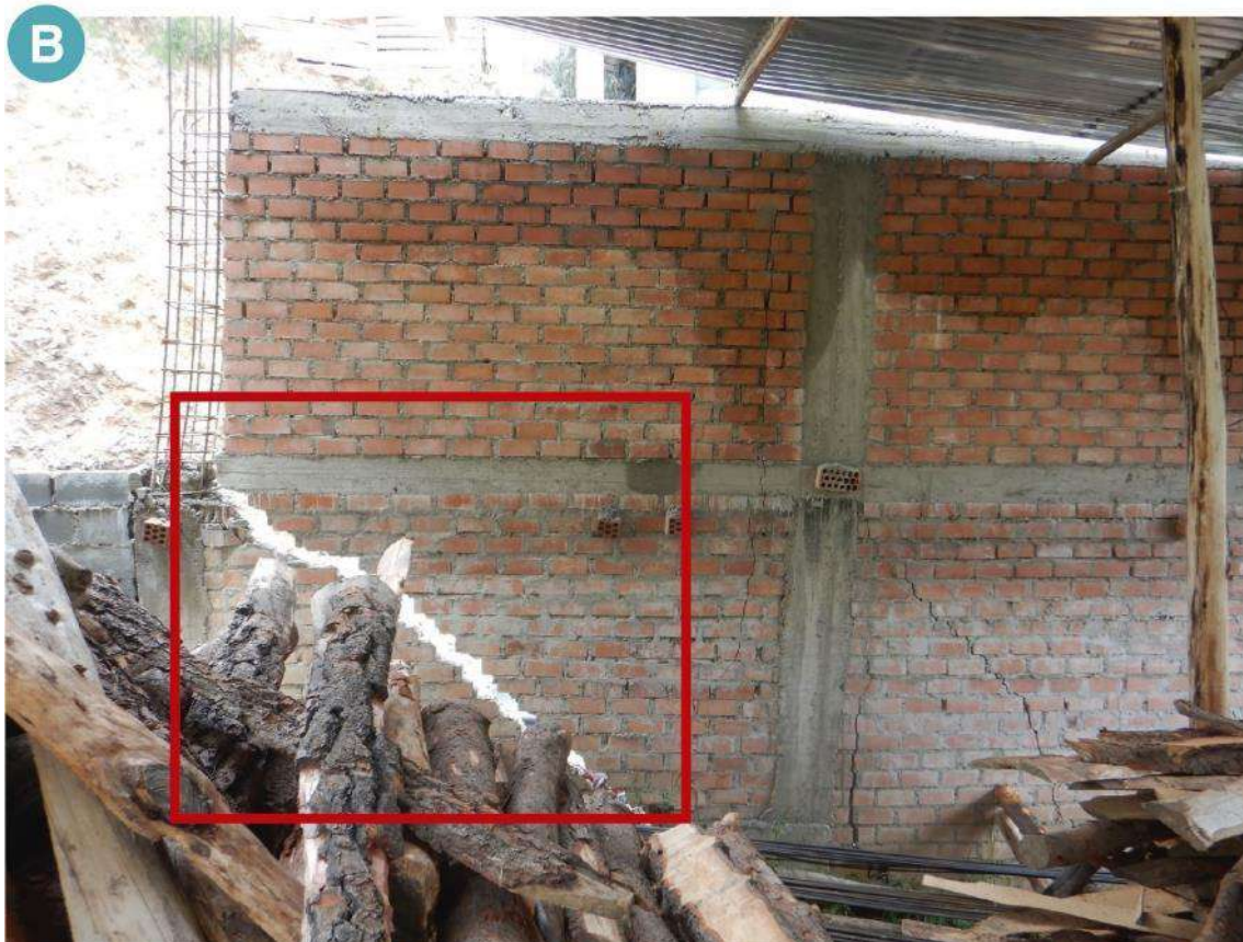
Figura 24. Muestra los daños en la construcción n° 6 por el deslizamiento D4, A y B, muestran los agrietamientos en los muros de división de la propiedad.
