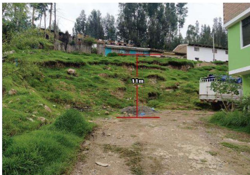
Figura 18. Muestra el talud para construcción de viviendas y las casas agrietadas en la parte superior.
