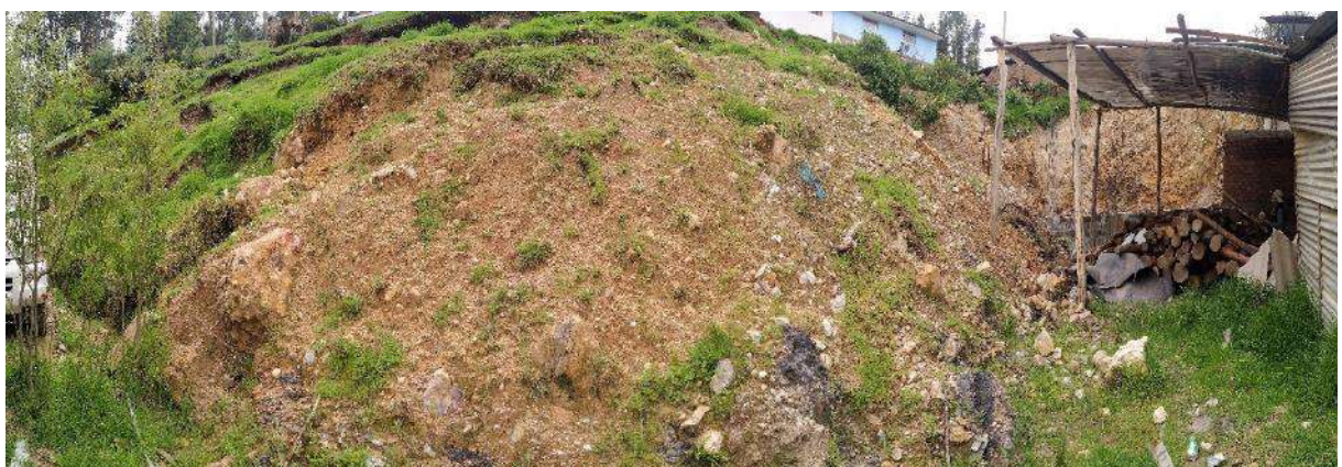
Figura 11. Depósitos coluvio-deluviales ubicados en la coordenada UTM WGS 84, 18s Este: 221628 y Norte: 8951018. Por debajo de las casas con agrietamientos.
