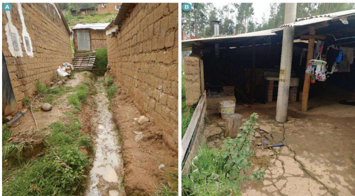
Figura 25. Muestra agrietamientos en la vivienda N°1 afectada por la reptación de suelos, A), muestra la escorrentía de agua y B) agrietamientos cercanos a un poste de energía eléctrica.
