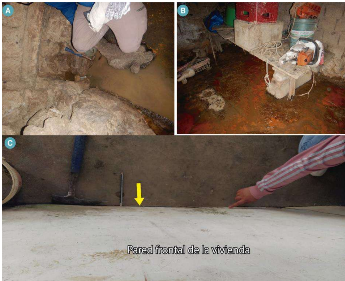
Figura 21. Muestra los daños en la vivienda n° 2 por el deslizamiento D4, las flechas amarillas señalan la dirección del movimiento perpendicular a la pendiente. A) y B) Muestran filtraciones de agua y C) agrietamientos centimétricos de la pared principal de la vivienda.
