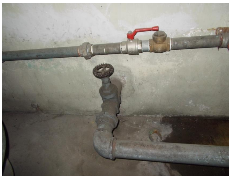
Figura 72. Tuberías no tienen uniones flexibles en cisterna.
