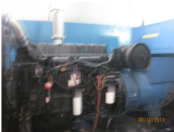
2.- Grupo electrónico de emergencia de 350kw.
