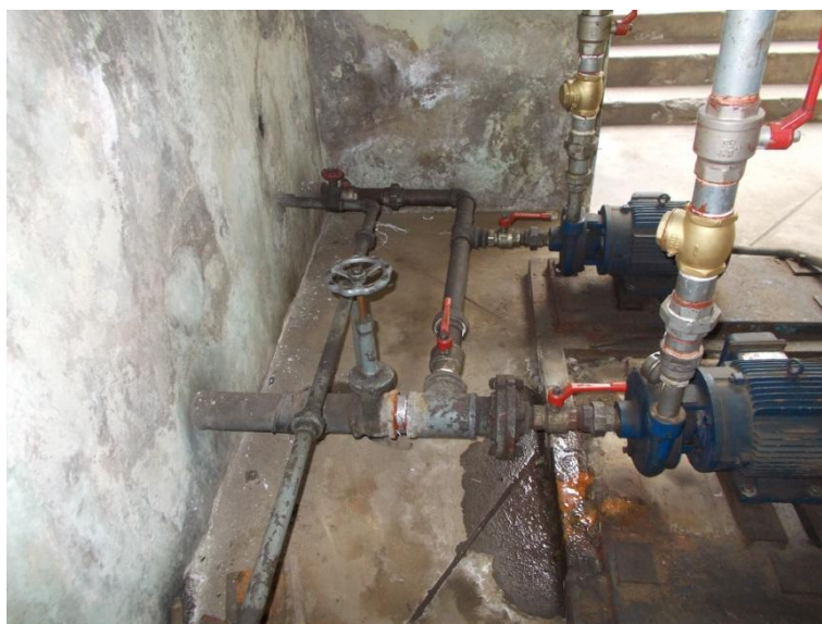
Figura 81. Línea de succión rígida con cisterna, fuga de agua y filtración en la pared de la cisterna.
