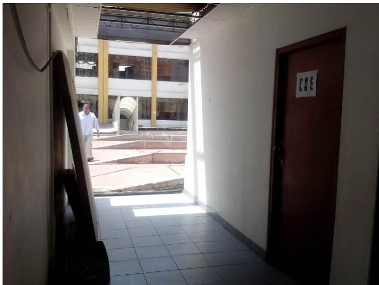
Foto 22. Acceso al COE a través del techo.
