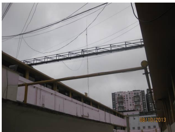
11. Canalizaciones y pase de instalaciones eléctricas entre pabellones y Cables de comunicaciones colgantes en desorden
