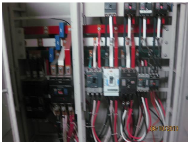
9. Tablero eléctrico sin mandil de protección
