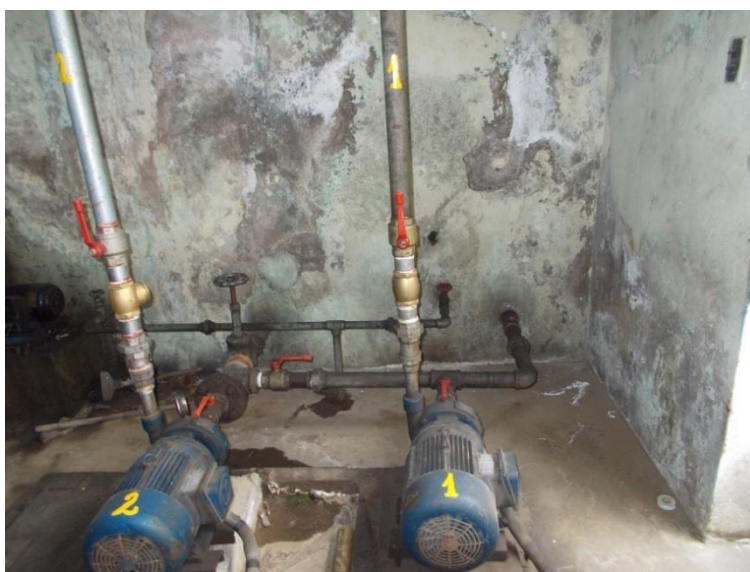
Figura 78. Pared de cisterna con humedecimiento que produce corrosión en las tuberías.
