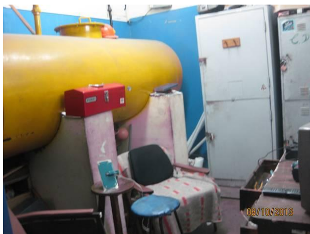
5. Tanque de petróleo con materiales, escritorios y vestuarios
