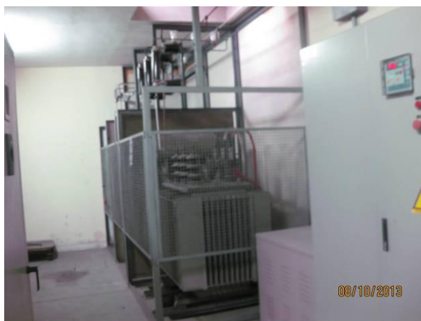
3. Sub estación eléctrica exclusiva para el hospital
