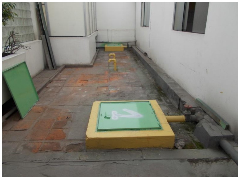
Figura 79. Tapa de cisterna inadecuada permite contaminación.
