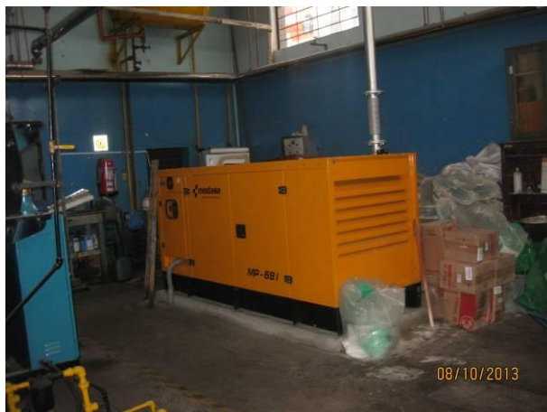
1.-Grupo Electrónico de 74 kw relativamente nuevo, abastece áreas críticas
