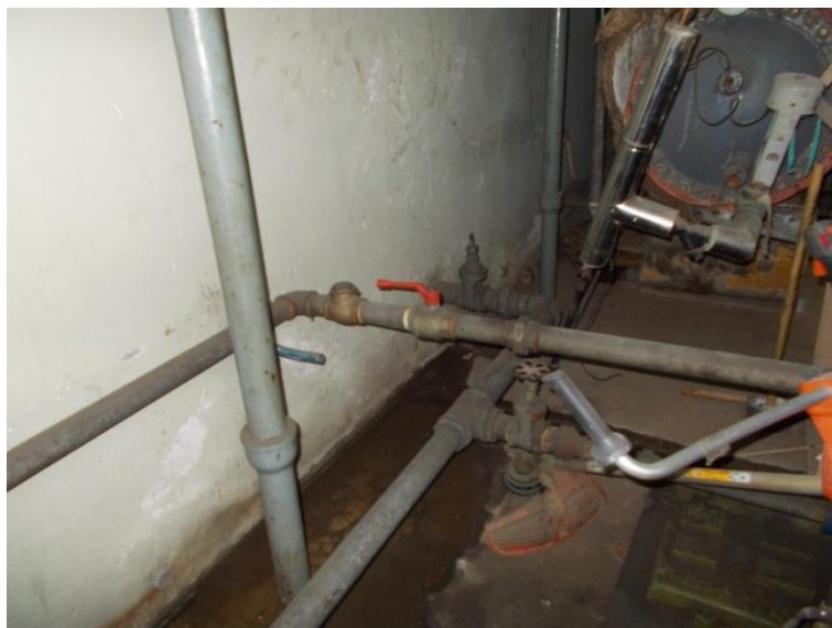
Figura 73. Válvulas inoperativas en árbol de descarga.
