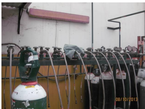
12 Manifold de oxígeno de emergencia sin balones
