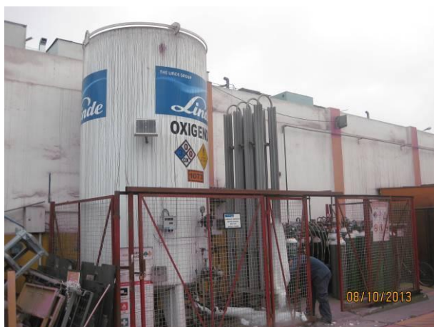
14. Tanque criogénico de oxígeno y manifold sin caseta y con materiales de desperdicios
