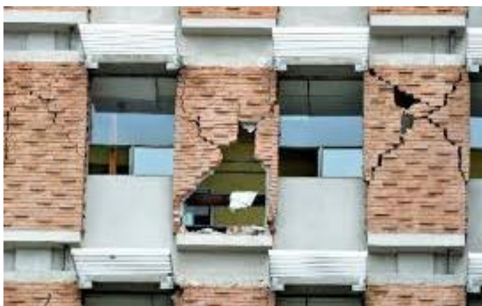
Figura 3. Baldosas en fachadas, que se desprenden por efecto de sismos intensos.
