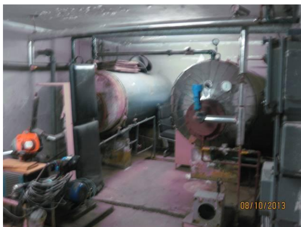
6. Instalaciones de vapor en el sótano
