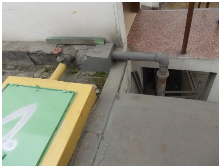
Figura 80. Redes de agua presentan corrosión por intemperismo
