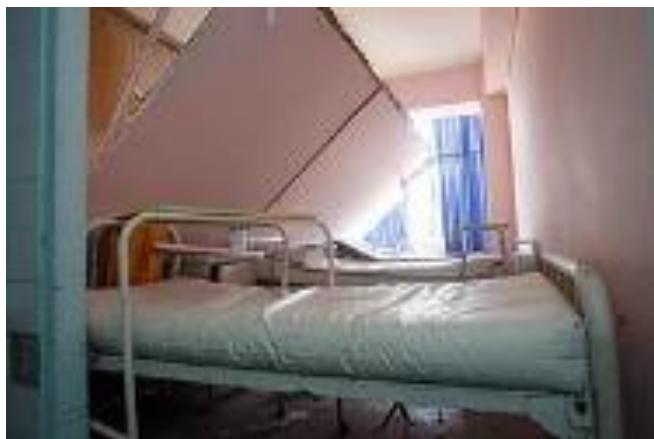
Figura 2. Tabiques no asegurados adecuadamente, corren el riesgo de deformaciones o caídas ante eventos adversos.
