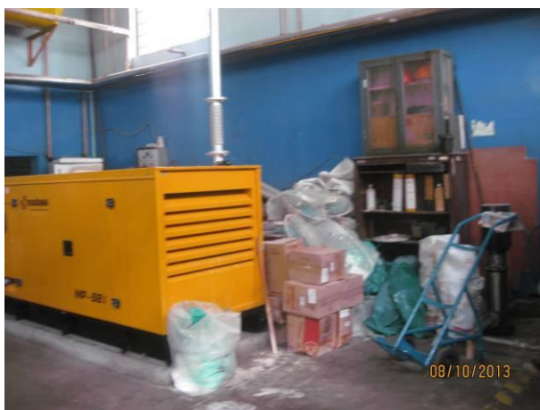
8. Ambiente de grupo electrógeno con materiales en desuso
