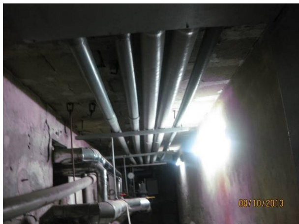
10 Instalaciones térmicas en ducto de instalaciones
