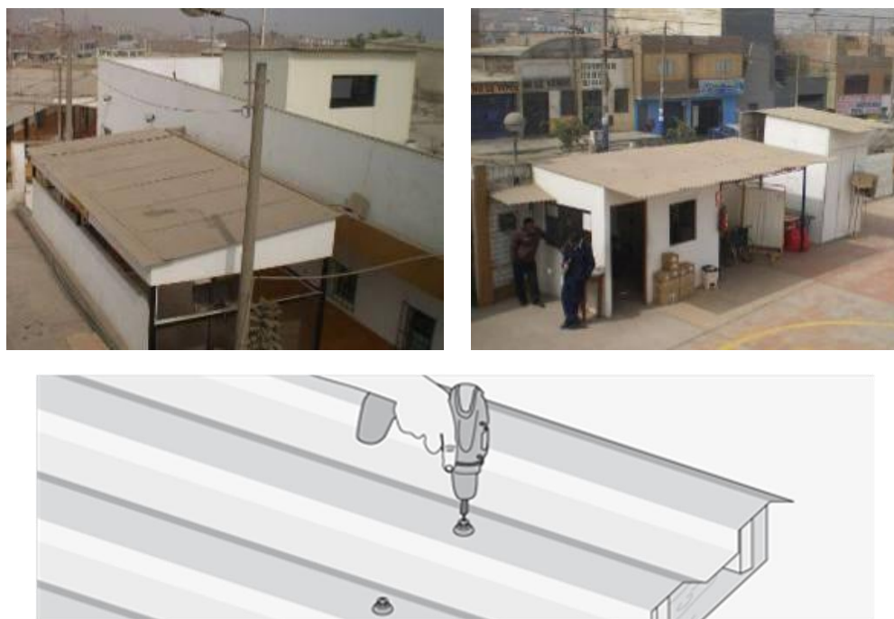
Figura 5. Techos ligeros que deben estar sujetos adecuadamente a fin evitar caídas o desprendimientos.
