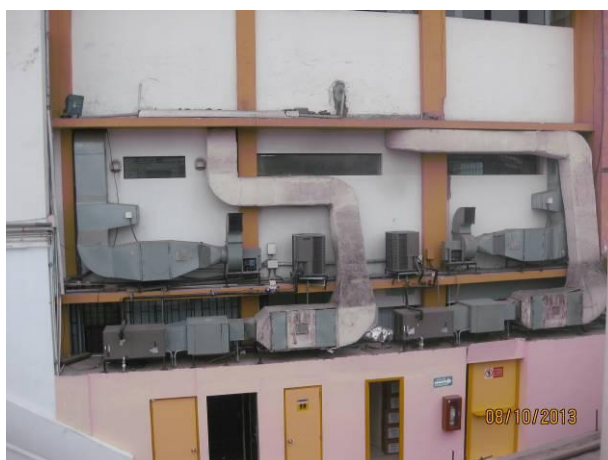
15. Sistema de aire acondicionado de áreas críticas con equipos acondicionados
