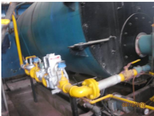
6. instalaciones de gas para el caldero
