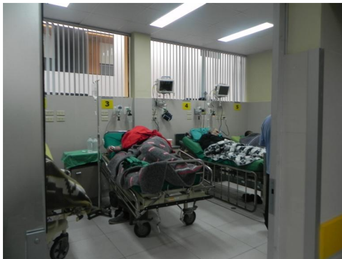
Foto 35: En el pabellón A los equipos de monitoreo que funcionan con abastecimiento eléctrico se encuentran bien sujetos y empotrados contra la pared.
