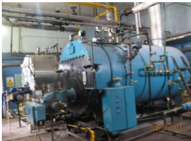
4. Generador de Vapor en sala de maquinas
