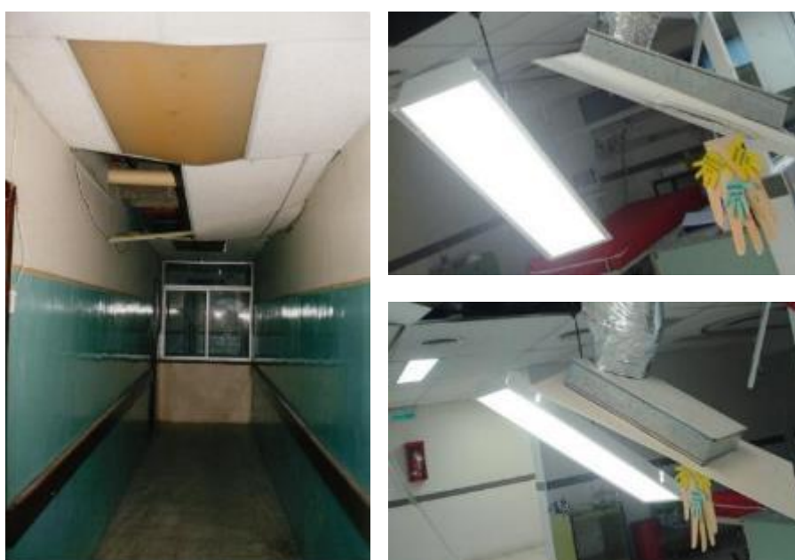
Figura 4. Falsos cielos rasos se desprenden por deficiencia en anclajes ante movimientos sísmicos
