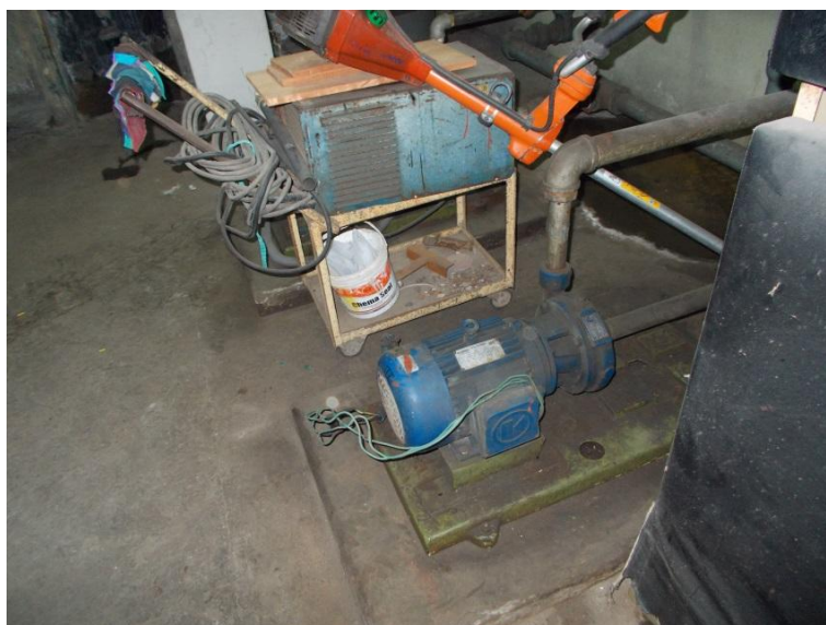
Figura 76. Conexiones eléctricas improvisadas, tubería sin protección para corrosión.
