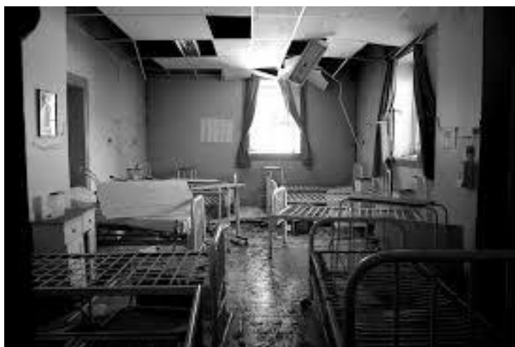
Figura 8. Luminarias no sujetadas adecuadamente en techo ante movimientos sísmos, se caen e incrementan el peso del falso cielo raso provocando colapso de los sistemas.
