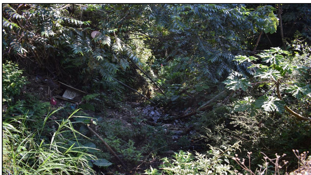
FIGURA N°03: VISTA DE LECHO COLMATADO DE SEDIMENTOS Y MALEZAS DE QUEBRADA CHAYANAHUAYCCO
