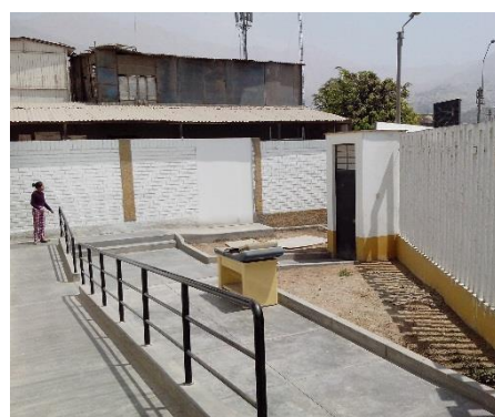
Foto 62. La vía de evacuación ha sido cerrada con un ambiente de archivo de historias clínicas.
