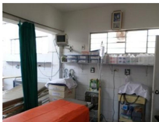
Foto 41. Seguridad de contenidos médicos, no están sujetos adecuadamente, riesgo de caída.
