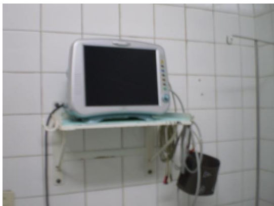
Foto 57. Equipo médico no se encuentra fijo o sujeto al estante. Se encuentra únicamente colocado encima. Presenta riesgo de volcamiento o caída.
