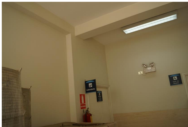
Foto 2. Laboratorio: Interacción entre pórticos y tabiques
