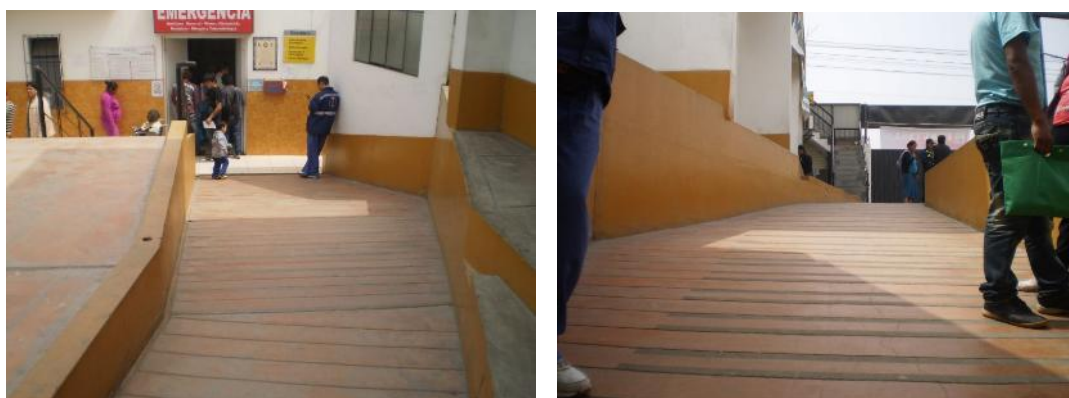
Foto 52. Rampas de acceso con pendientes muy pronunciadas, en el acceso para emergencia.
