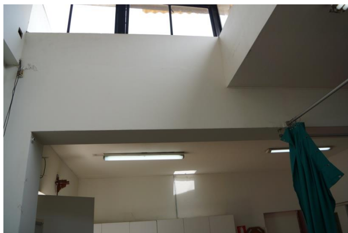
Foto 6. Emergencias: Detalle columna débil-viga fuerte
