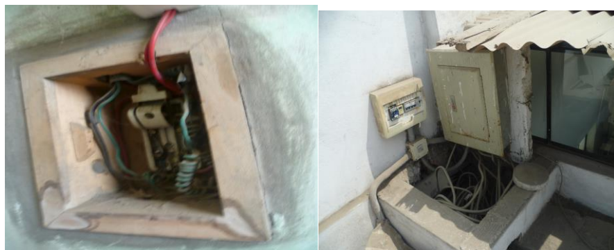
Foto 60. Instalaciones eléctricas infringen las normas
