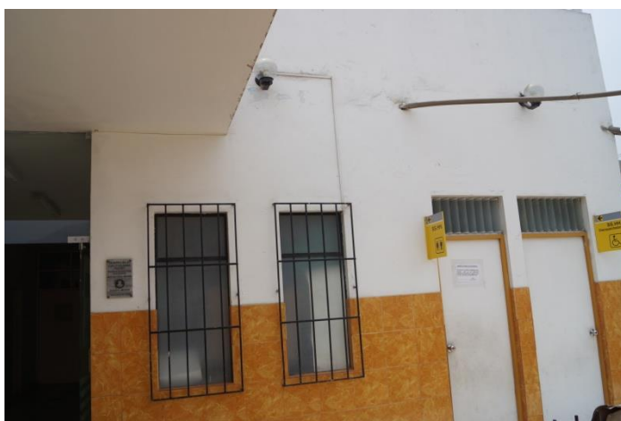
Foto 5. Emergencia: detalle de posibles columnas cortas
