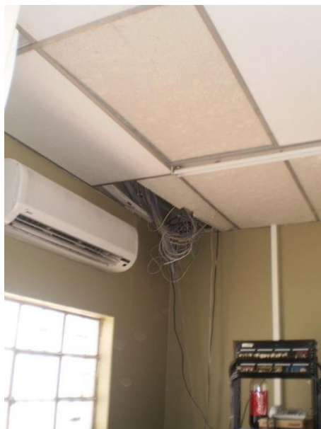
Foto 55. Cableado colgando de falso cielo raso muestran condiciones regulares de seguridad por no encontrarse fijados y su mala instalación. (Bloque B)
