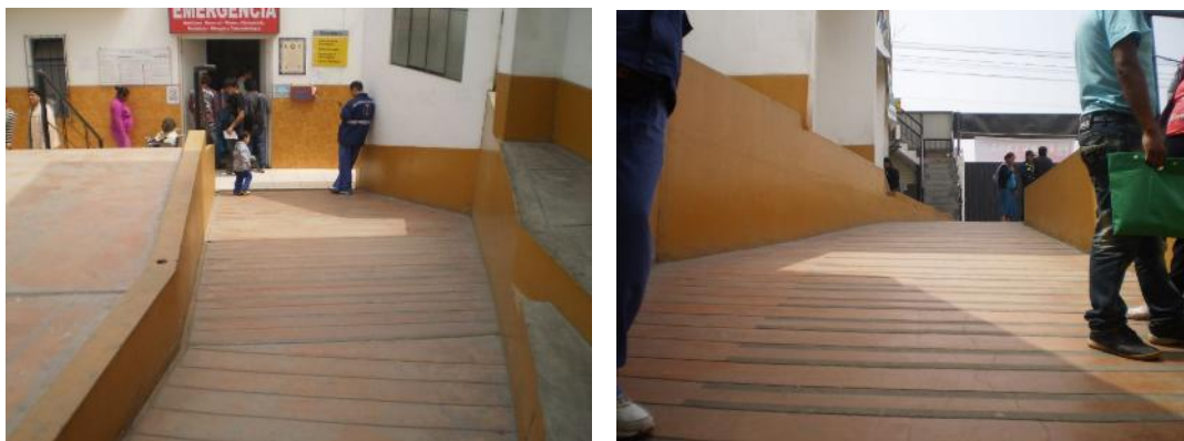
Foto 63. Rampas de acceso con pendientes muy pronunciadas, en el acceso para emergencia.
