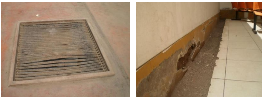
Fotos 49 y 50. Condición y seguridad de las cubiertas de los pisos.
