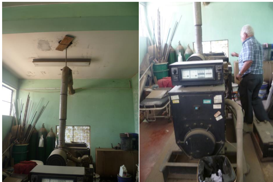
Foto 59. Ambiente de grupo electrógeno inadecuado
