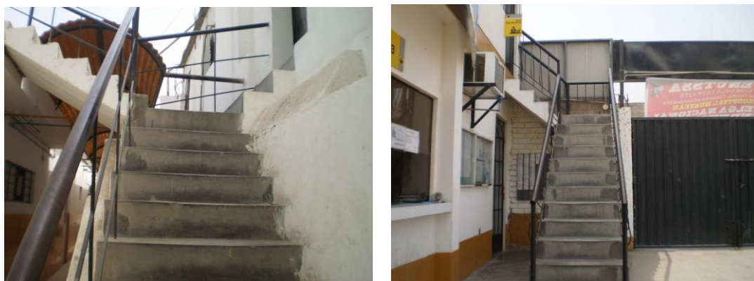
Foto 51. Las escaleras de acceso al área administrativa ubicada en el segundo piso tienen un mal dimensionamiento. Con barandas solo a un lado (foto izquierda - Bloque B) y muy empinada (foto derecha). En caso de emergencia el ancho es mínimo, por lo que no se cumplen con las normas de seguridad.
