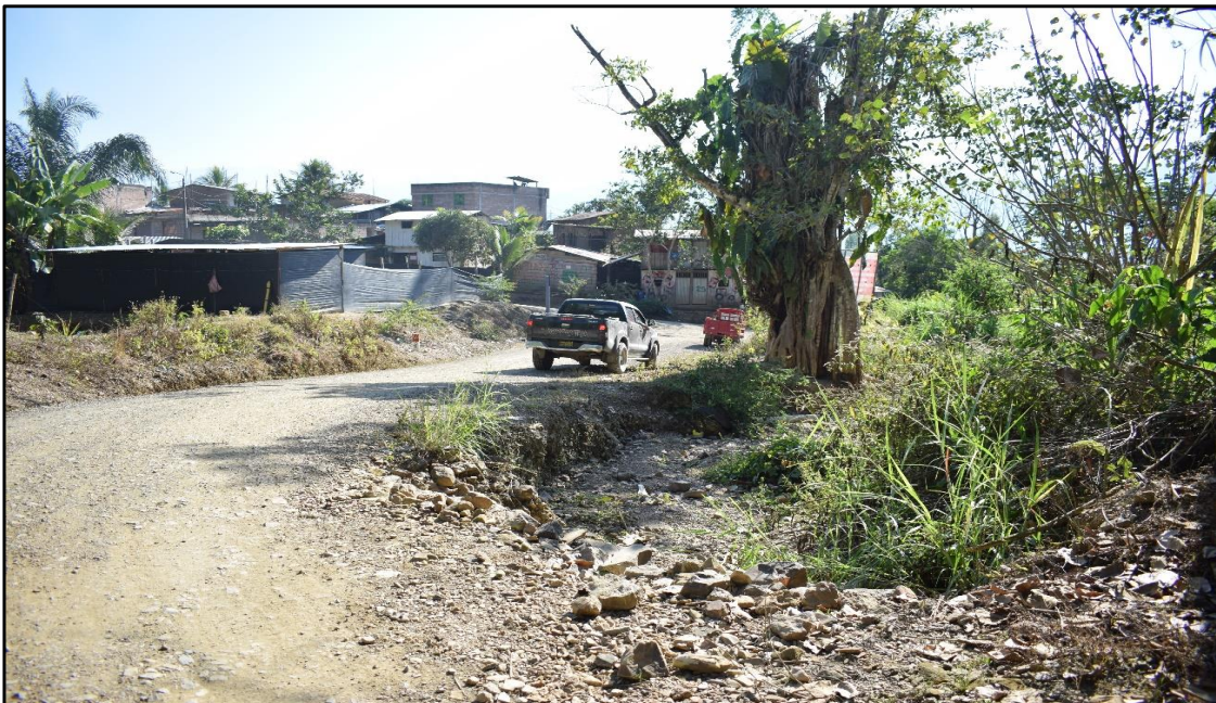
FIGURA N°03: VISTA DEL LECHO DE QUEBARADA CANALHUAYCCO JUSTO A VIA VECINAL DE LA LOCALIDAD DEL CANAL.
