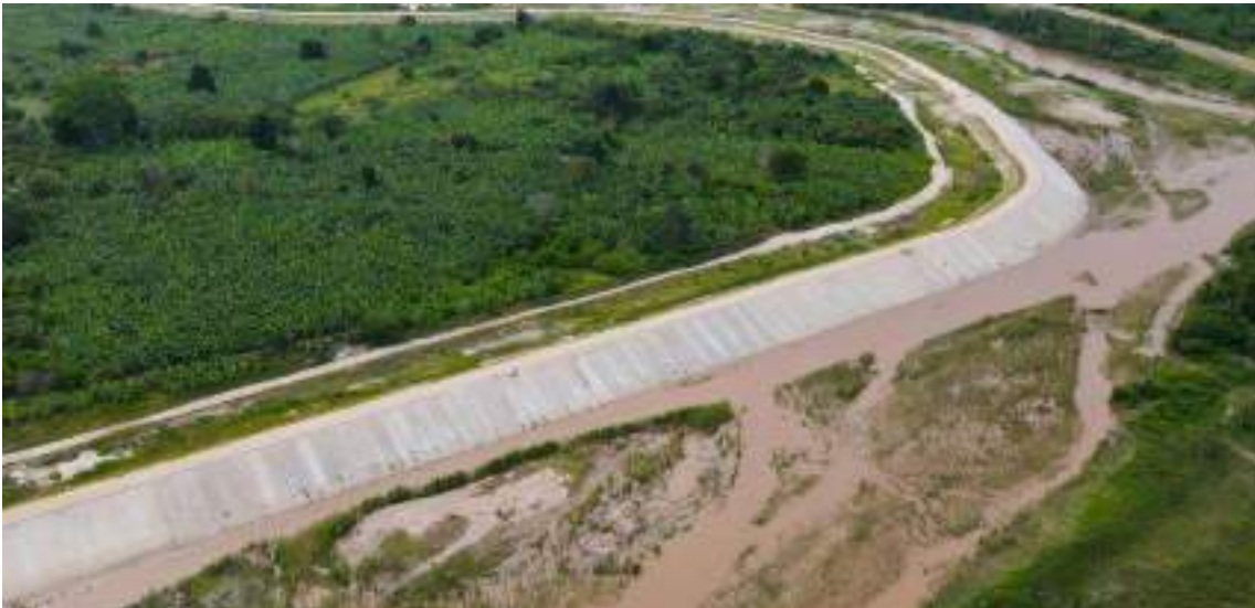
Fotografía 5. Ejemplo de una defensa ribereña con un muro de concreto.
