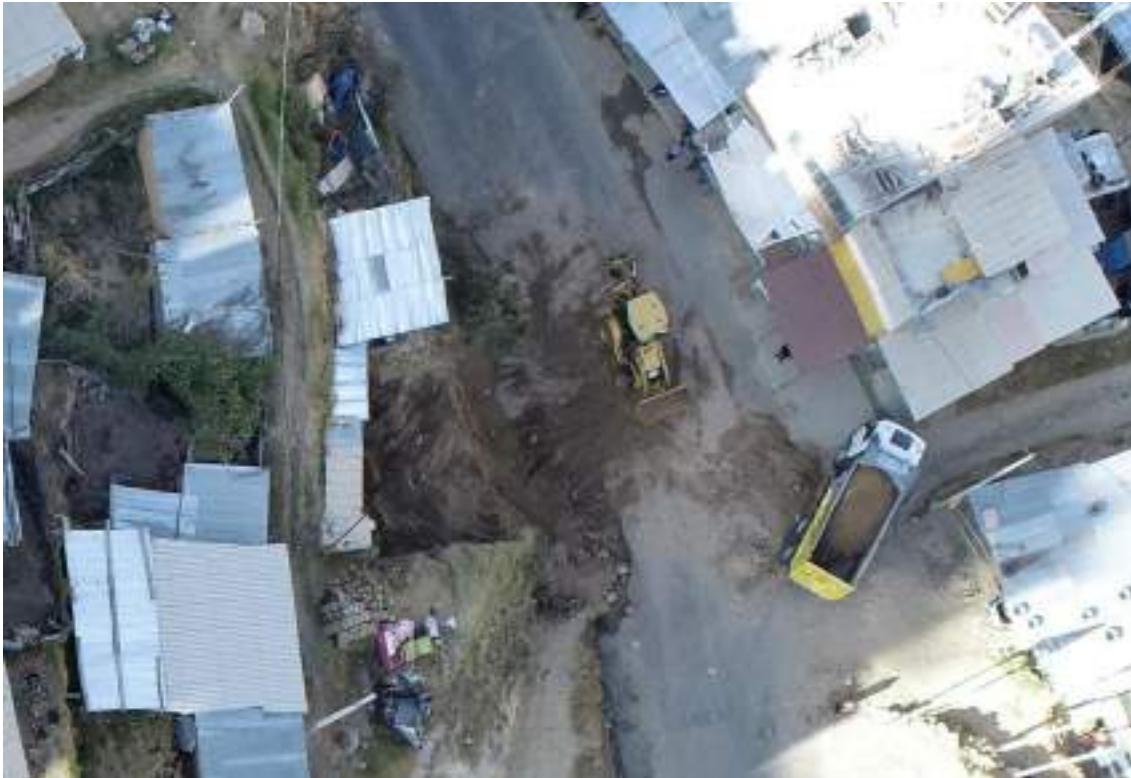
Fotografía 5: Cortes de talud con maquinaria (agosto 2022), hacia la margen izquierda del deslizamiento, para la construcción de nuevas viviendas. Estas condiciones inestabilizan la ladera.
