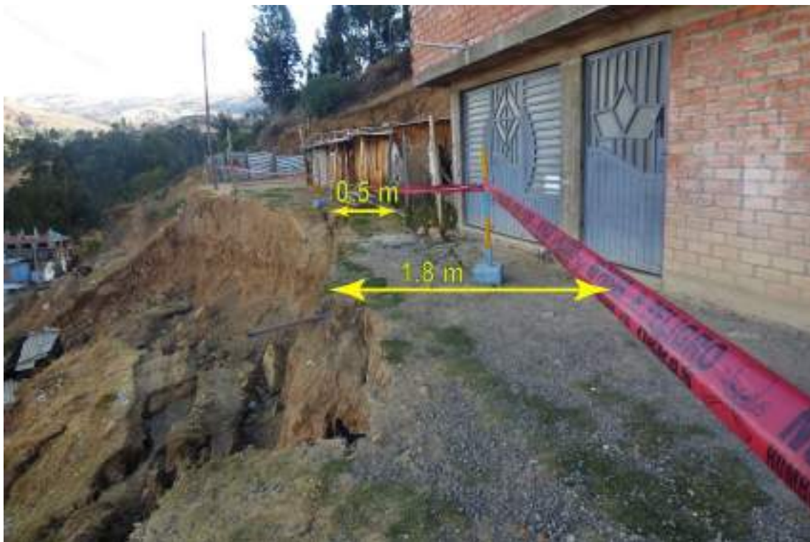
Figura 6: Viviendas ubicadas al borde de la escarpa principal del deslizamiento, las cuales se encuentran entre 0.5 a 1.8 m
